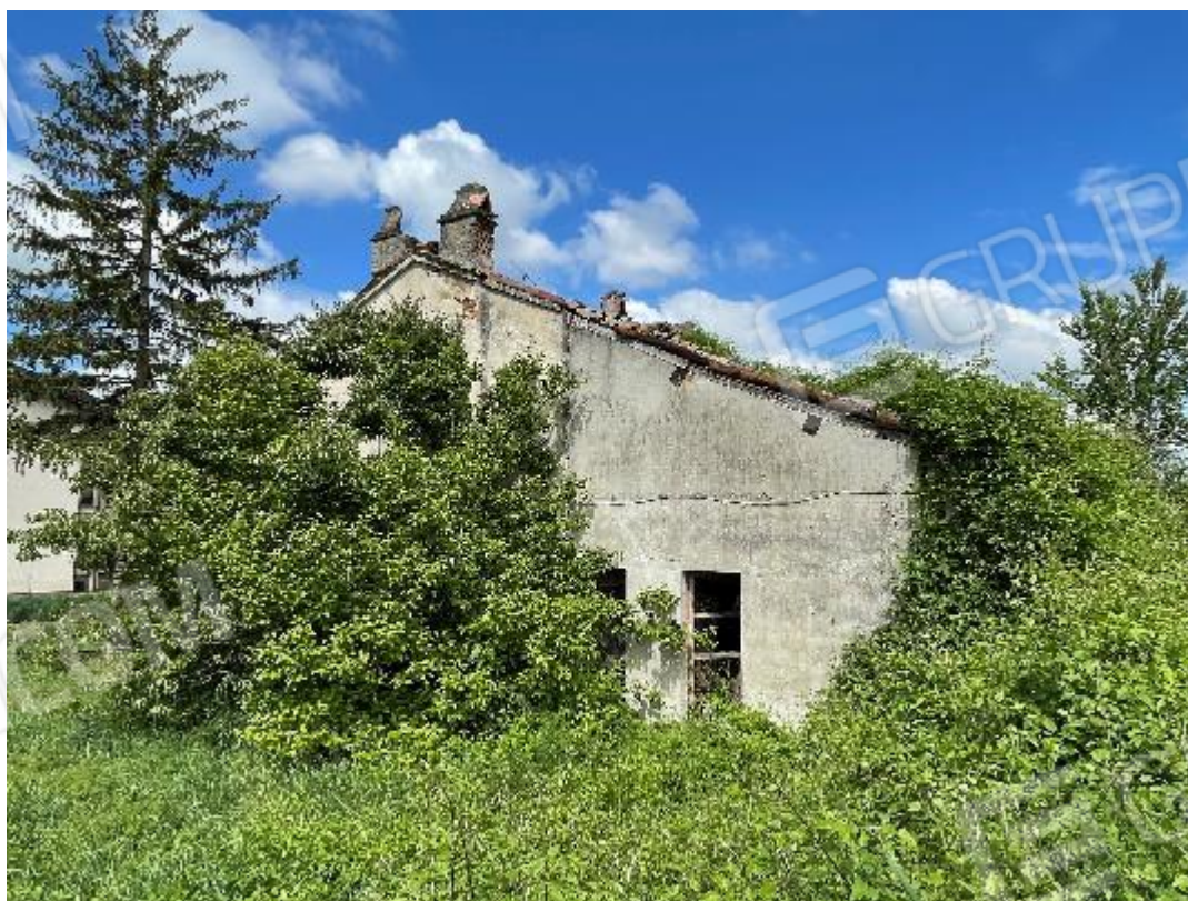
Immobile alla Particella 577 – Stato di degrado a abbandono – Prospetto Sud/Est
