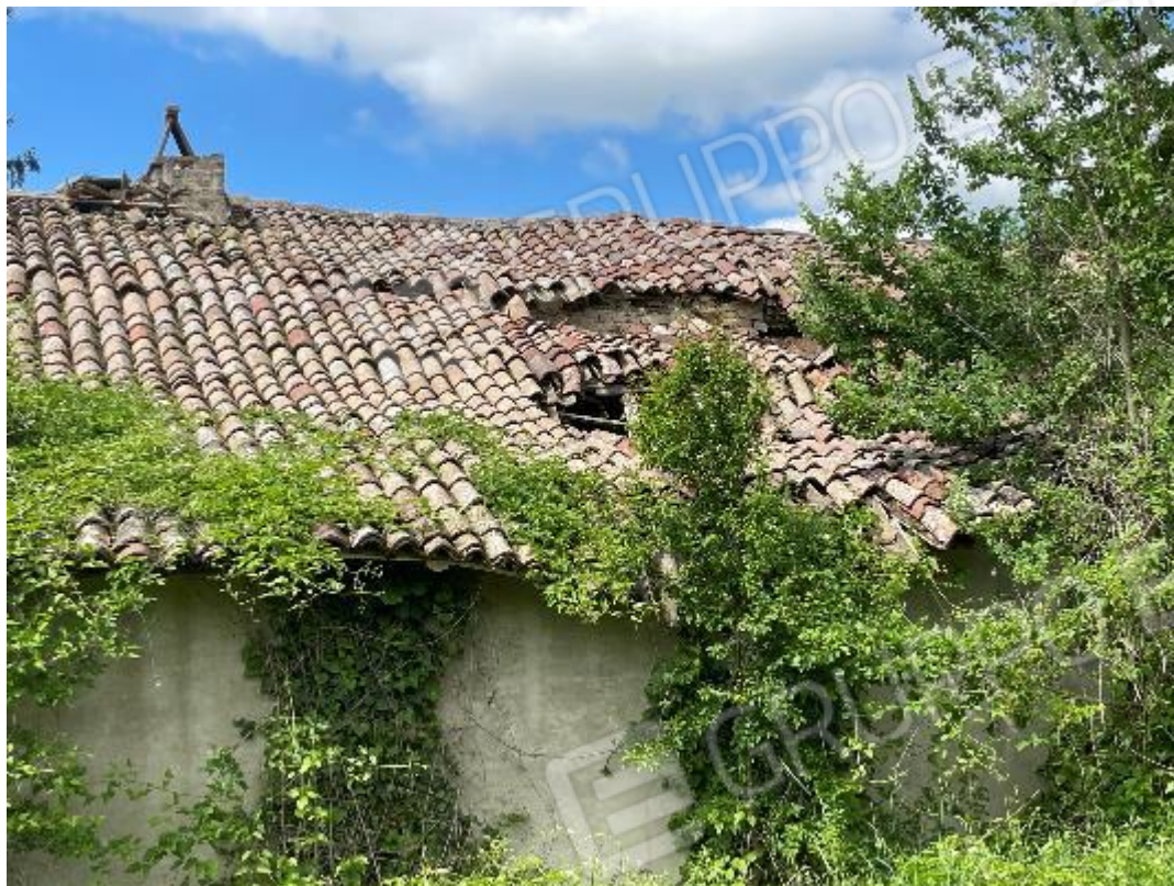
Immobile alla Particella 577 – Crollo e degrado della copertura
