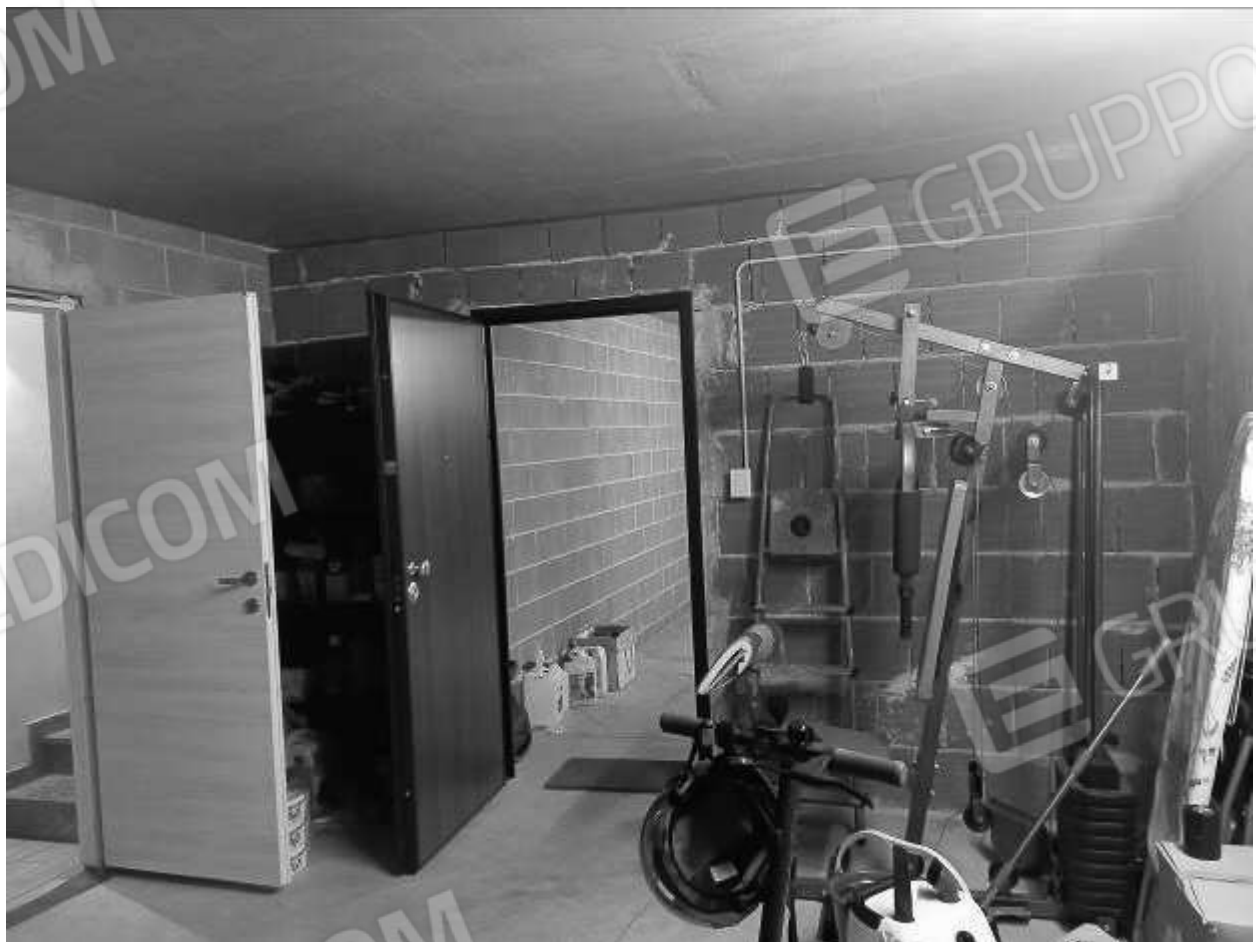
AUTORIMESSA - DIVISORIO NON AUTORIZZATO
