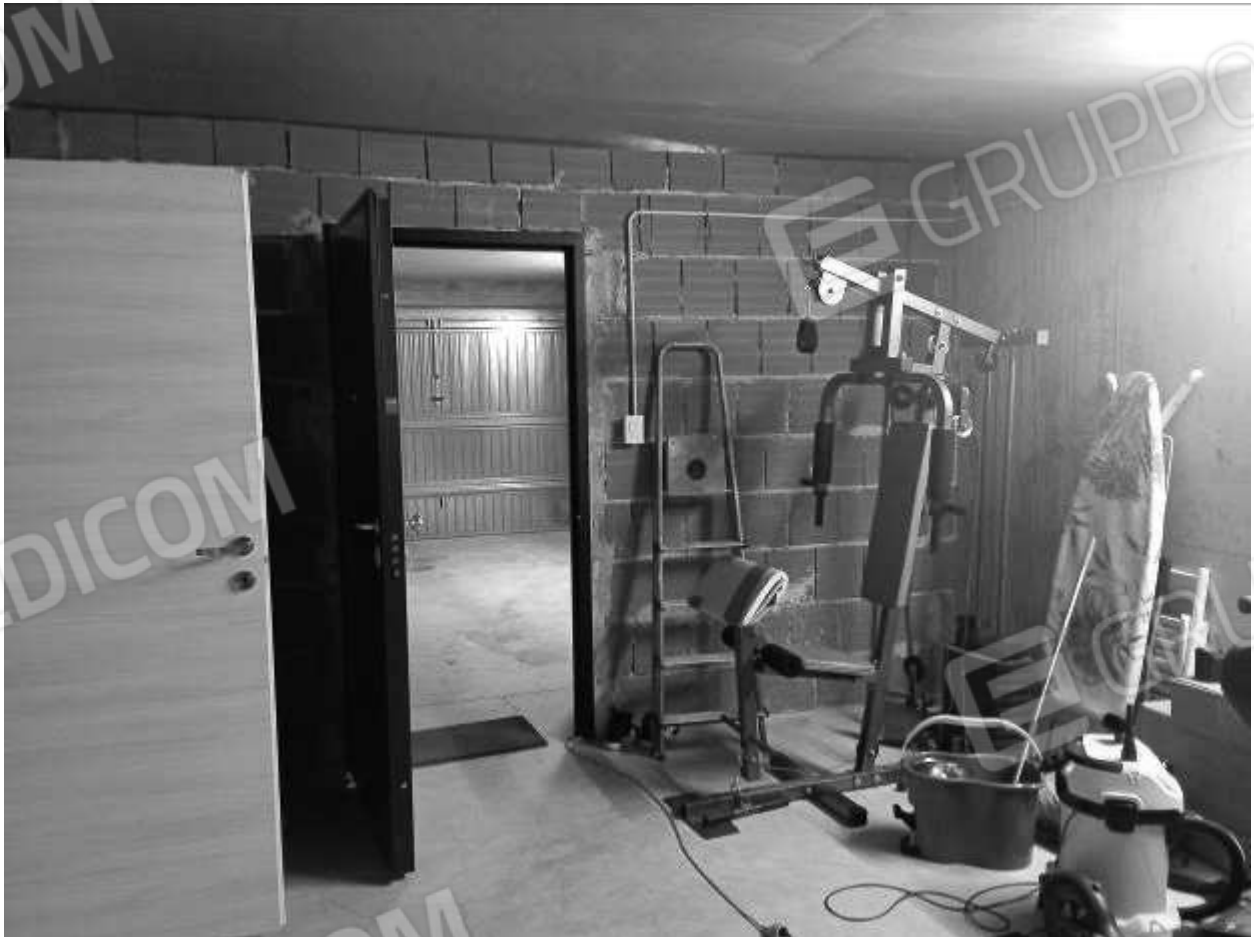
AUTORIMESSA - DIVISORIO NON AUTORIZZATO
