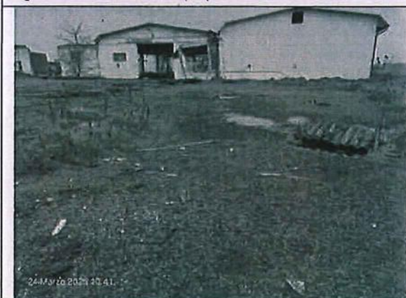
Fig. 49 Panoramica area con lastre e frammenti di fibrocemento
