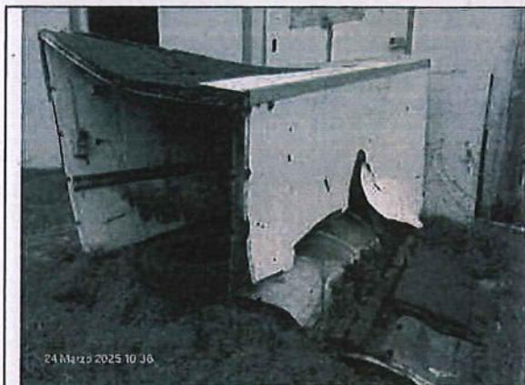
Fig. 69 Cella frigorifera semidistrutta
