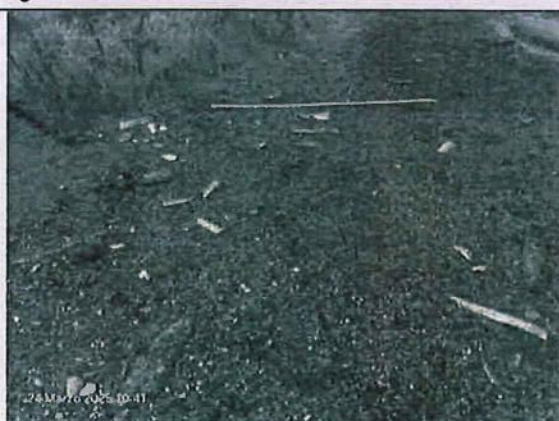
Fig. 50 Particolare frammenti sparsi di fibrocemento
