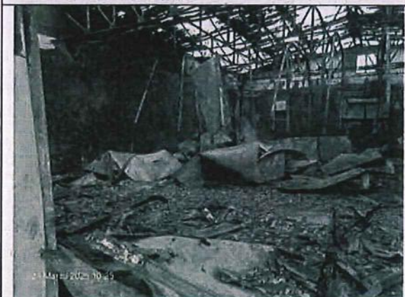
Fig. 59 Interno capannone oggetto dell'incendio
