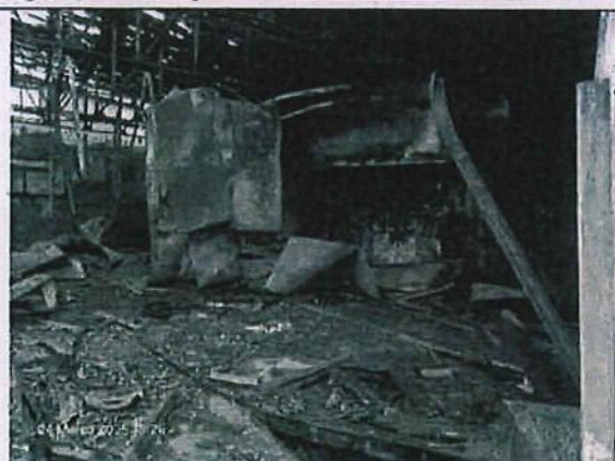
Fig. 60 Interno capannone oggetto dell'incendio
