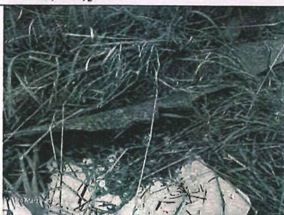
Fig. 10 Frammenti e lastre di fibrocemento - dettaglio
