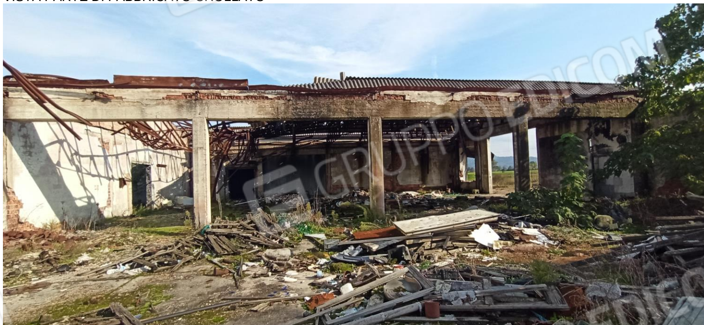
VISTA PARTE DI FABBRICATO CROLLATO
