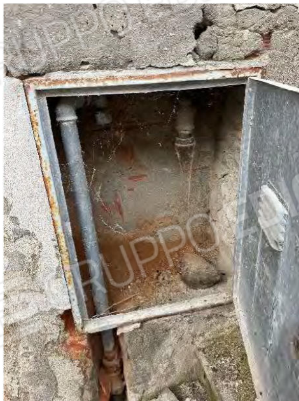
24. Vano esterno per contatore gas.
