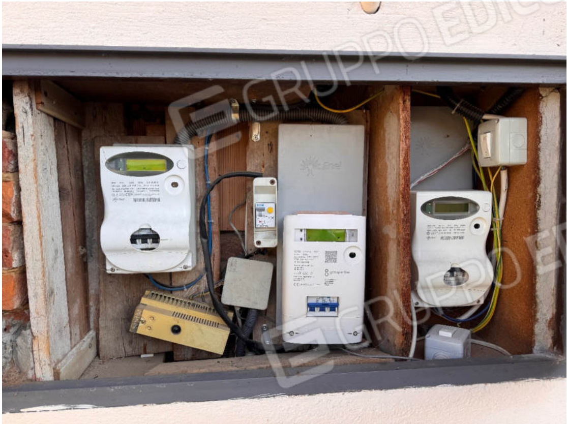
Contatore ENEL – quadro elettrico e magnetotermico
