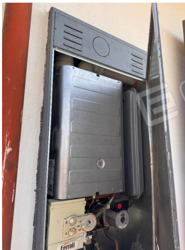
Calderina di Riscaldamento esterna con relativo cronotermostato
