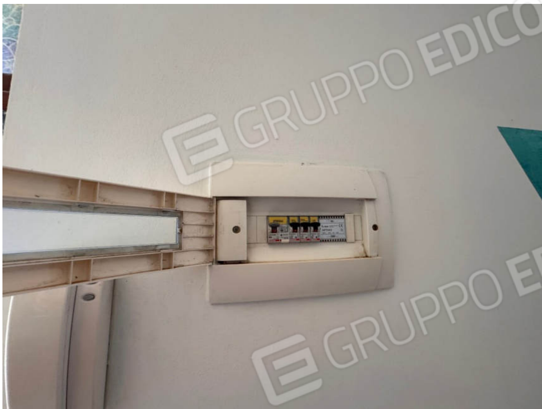
Particolare Centralino Elettrico
