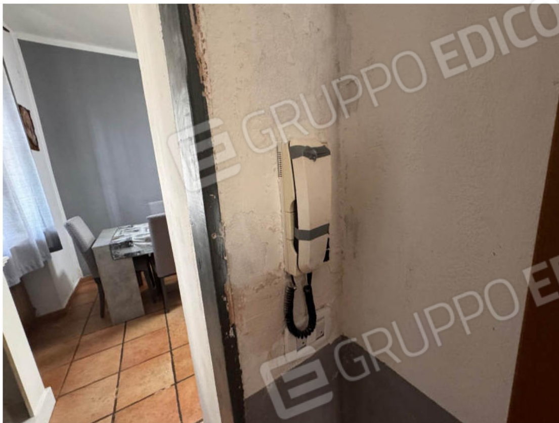
Corridoio – Citofono, particolare muro ammalorato
