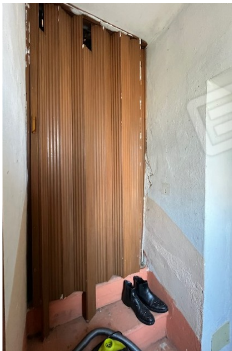
Porta di accesso al sottotetto non accessibile
