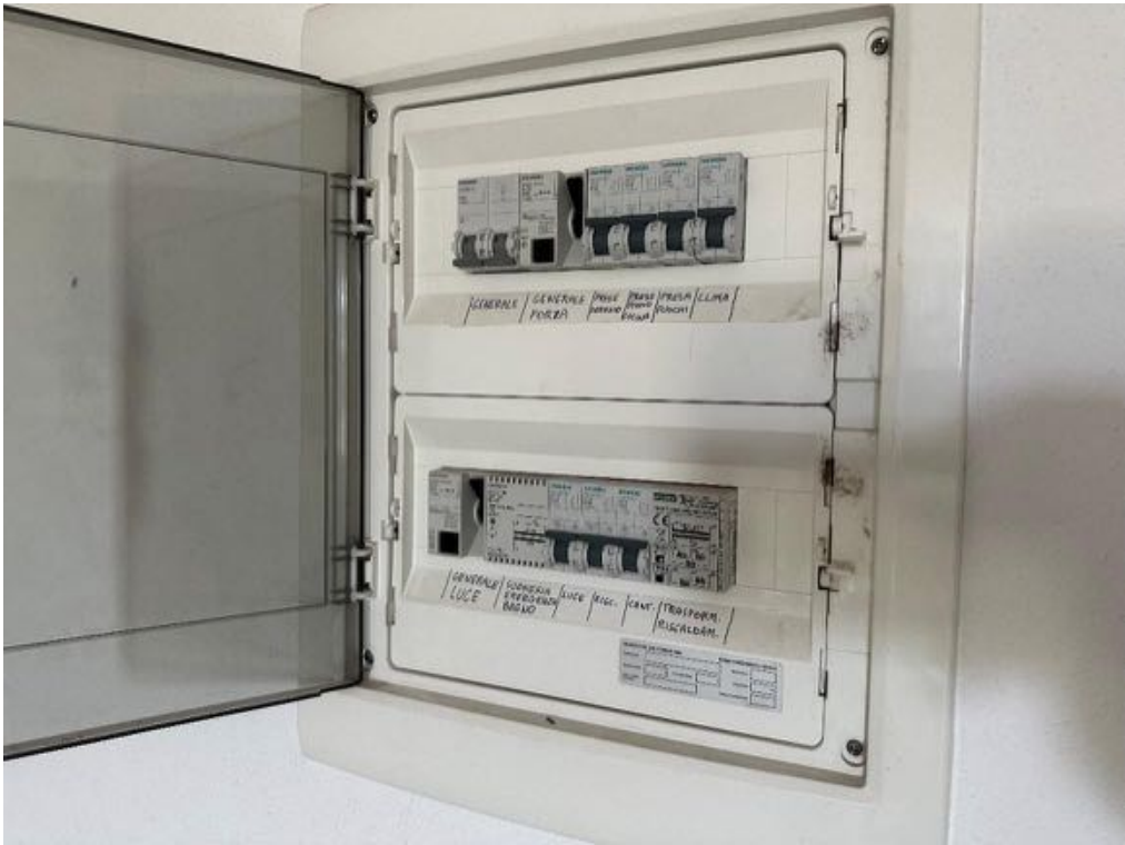
Piano Primo - Appartamento (Sub. 31) - Dettaglio - Quadro elettrico
