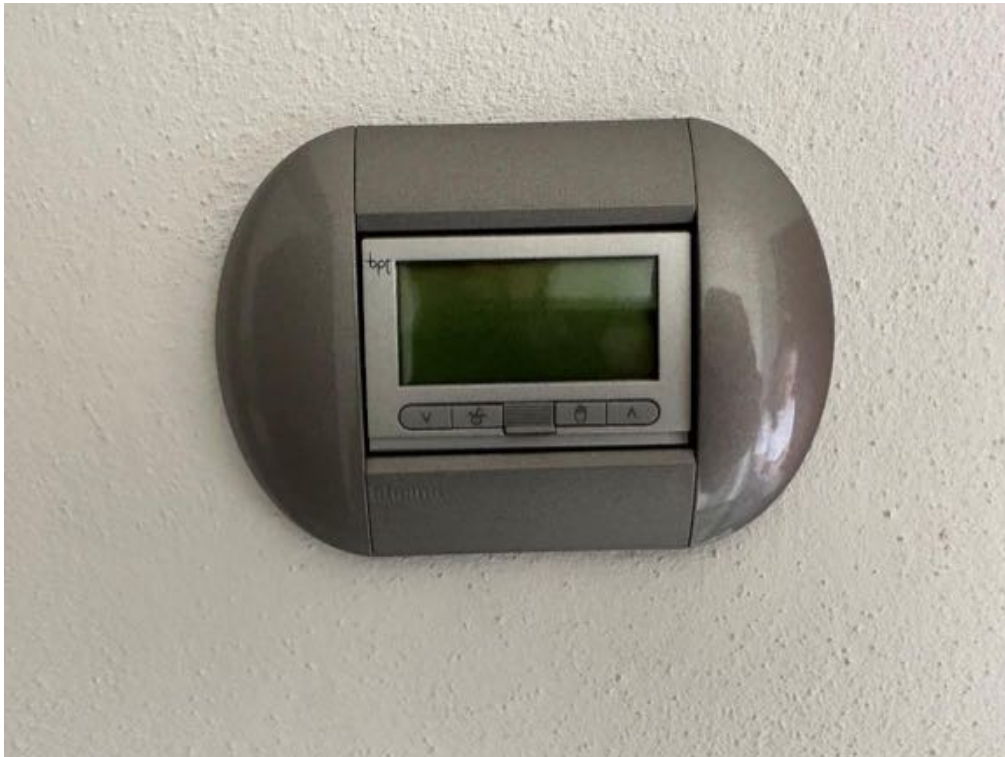
Piano Primo - Appartamento (Sub. 31) - Dettaglio - Termostato
