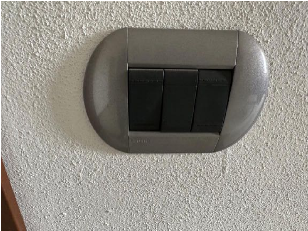
Piano Primo - Appartamento (Sub. 31) - Dettaglio - Frutti elettrici
