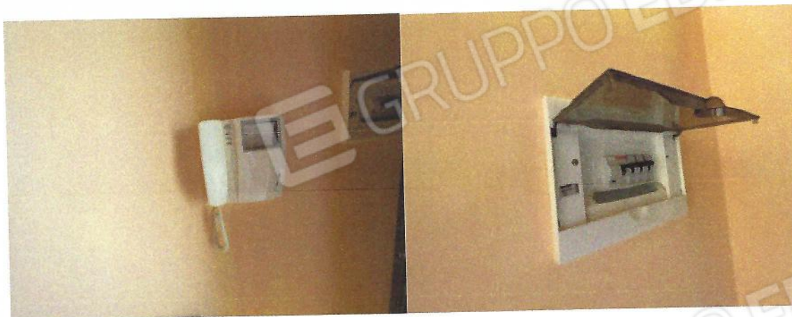
Particolare Video-Citofono e Quadro Elettrico Unità Immobiliare
