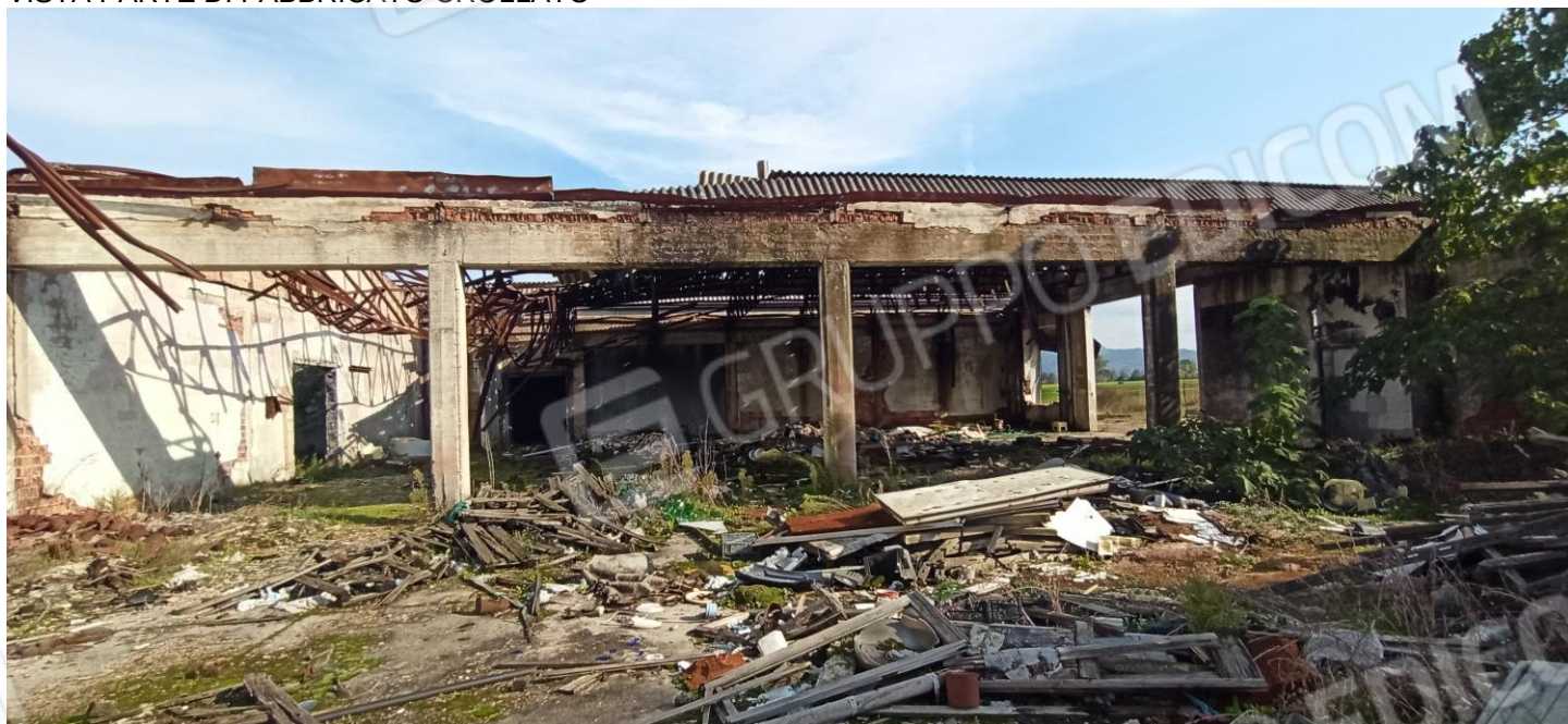
VISTA PARTE DI FABBRICATO CROLLATO
