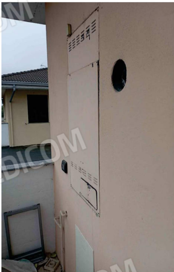
Caldaia a condensazione
