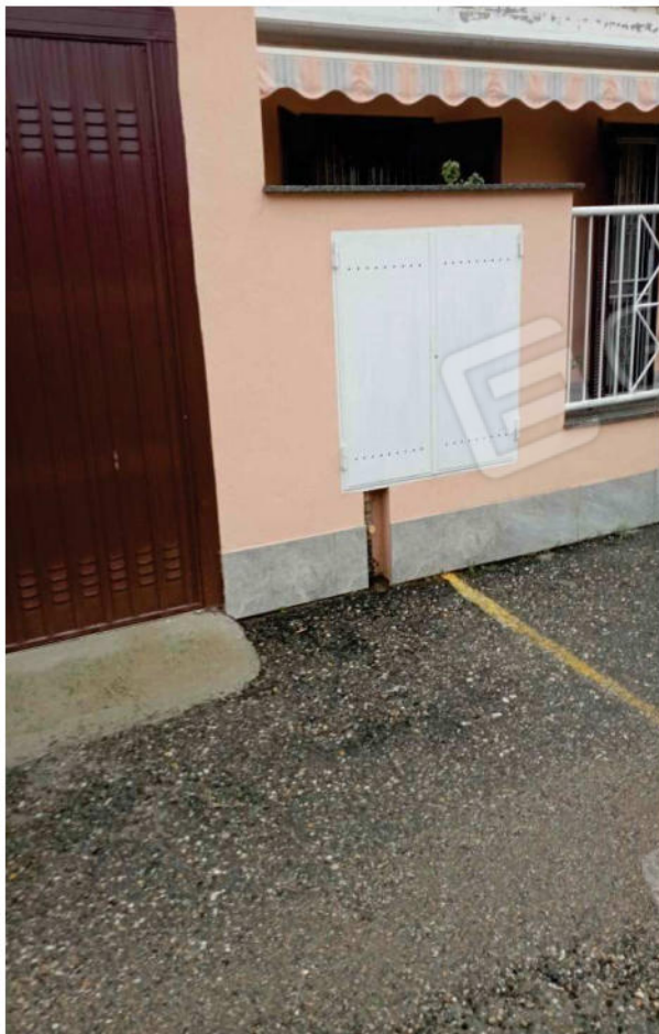
Alloggiamento contatori Gas su via Deledda
