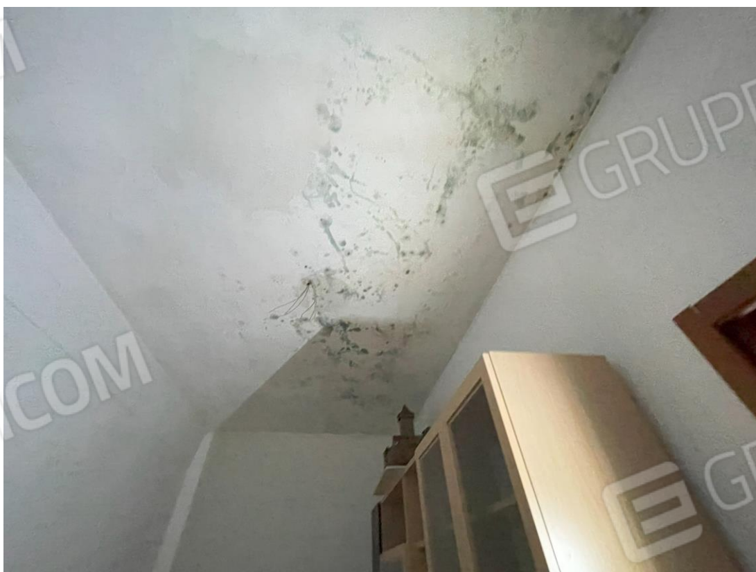
Foto 34. - Particolare infiltrazioni a soffitto nel disimpegno
