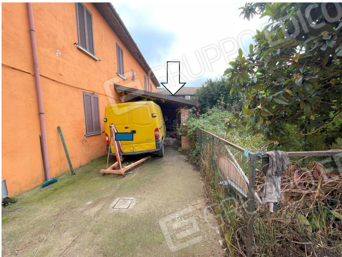
Foto 49. - Prospetto ovest e area esterna: si osservi la tettoia non autorizzata
