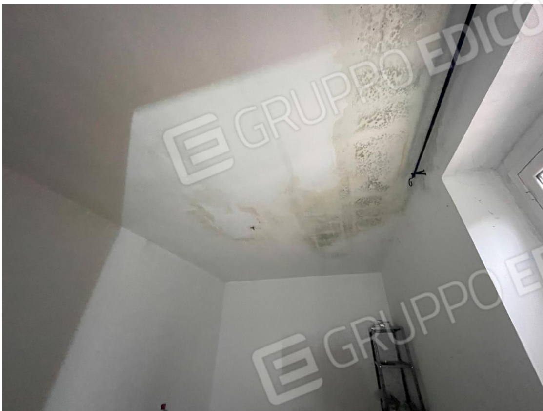
Foto 43. - Camera al primo piano: particolare infiltrazioni a soffitto
