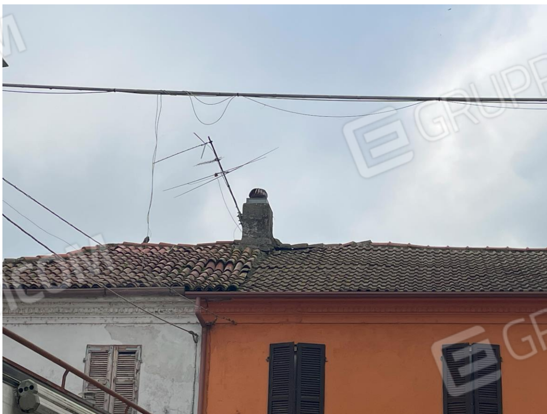
Foto 44. - Stato del tetto con problematiche di infiltrazione
