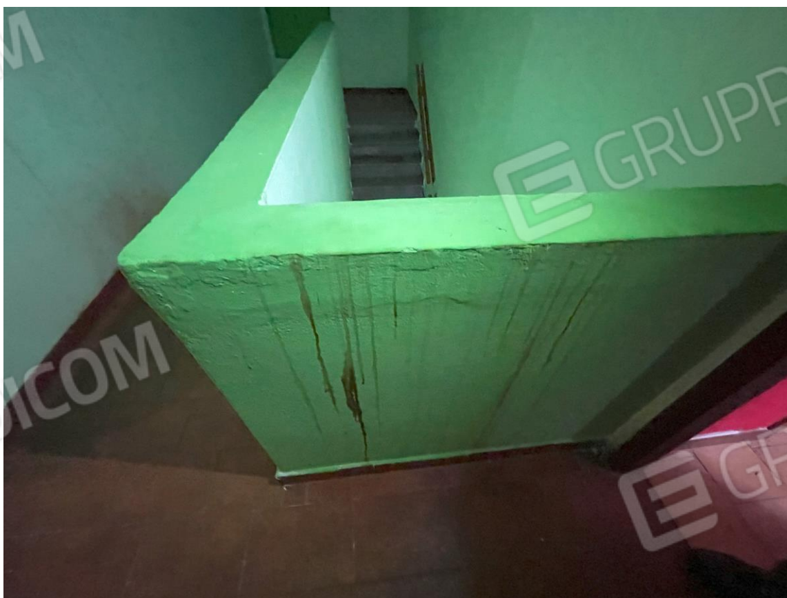
Foto 22. - Conseguenti colature sul parapetto della scala
