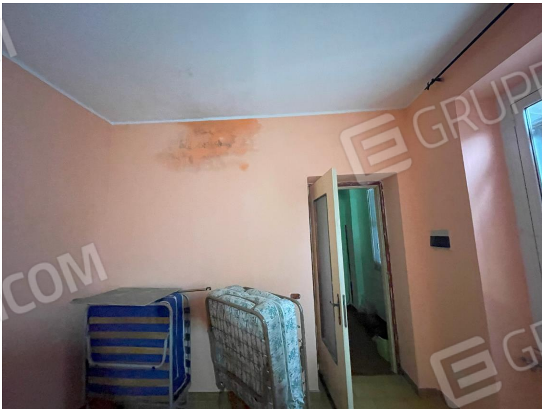
Foto 24. - Particolare macchie di infiltrazione a soffitto e parete
