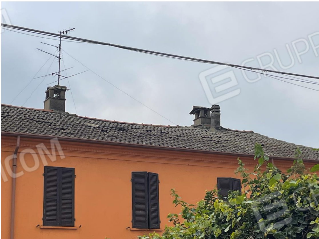
Foto 46. - Stato del tetto con problematiche di infiltrazione
