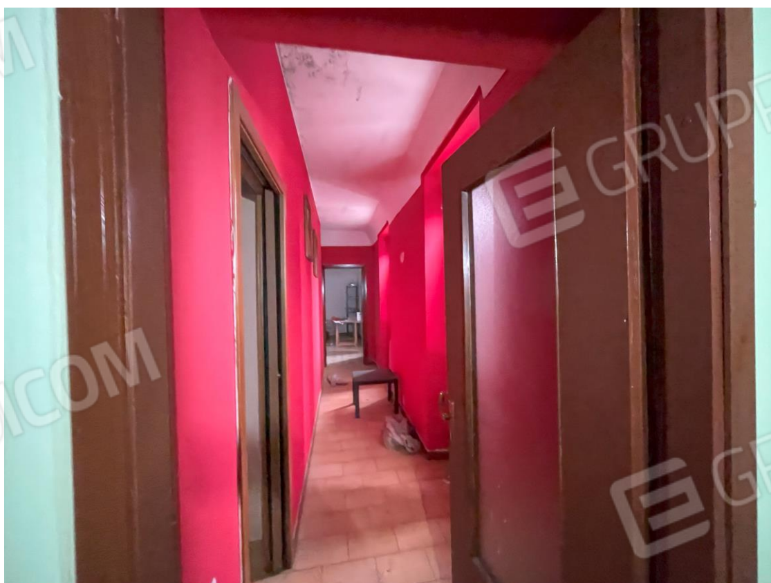
Foto 32. - Corridoio piano primo con evidenza di infiltrazioni a soffitto
