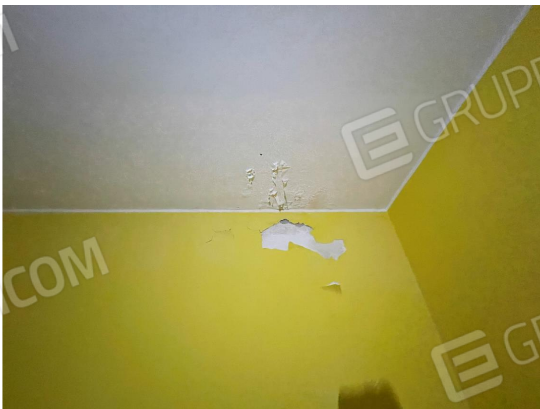
Foto 40. - Particolare infiltrazioni a soffitto e a parete
