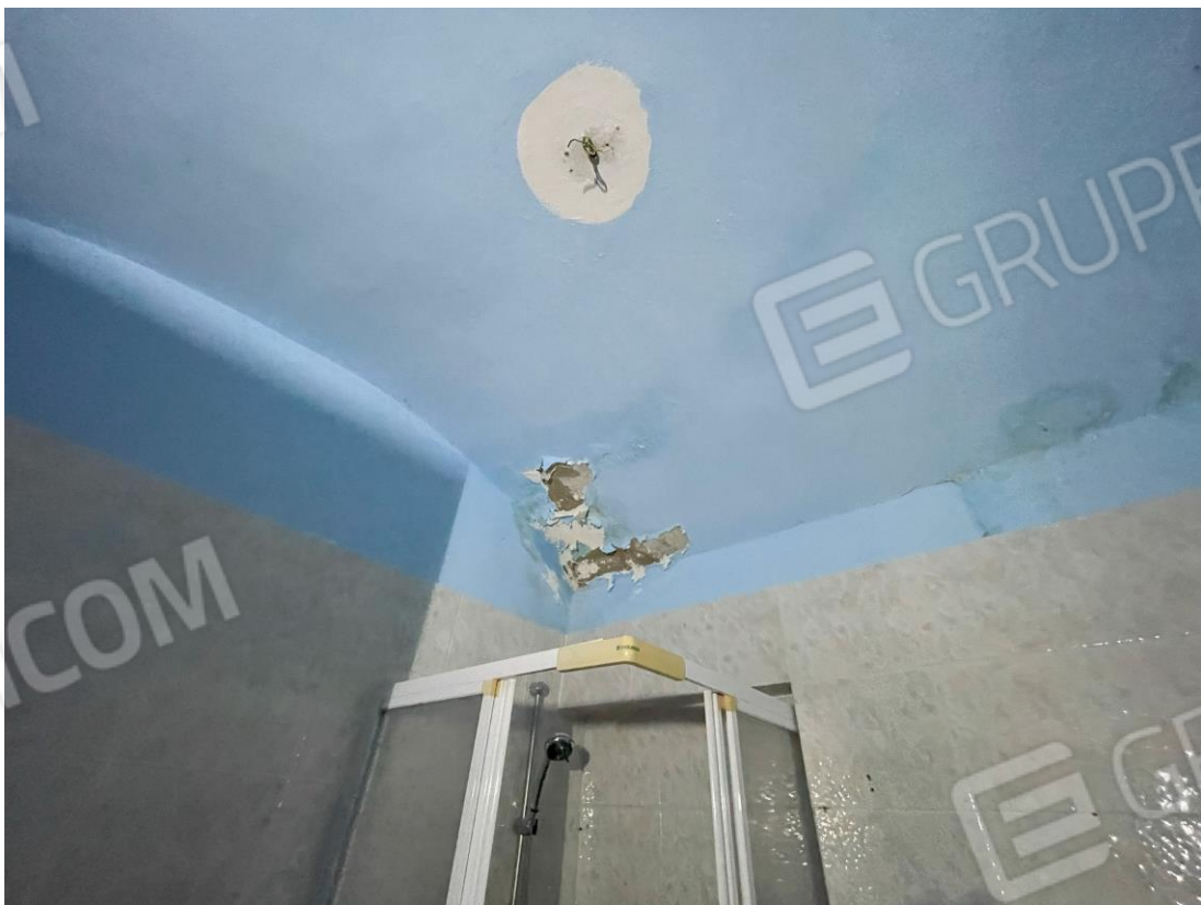
Foto 30. - Bagno 2 particolare infiltrazioni a soffitto
