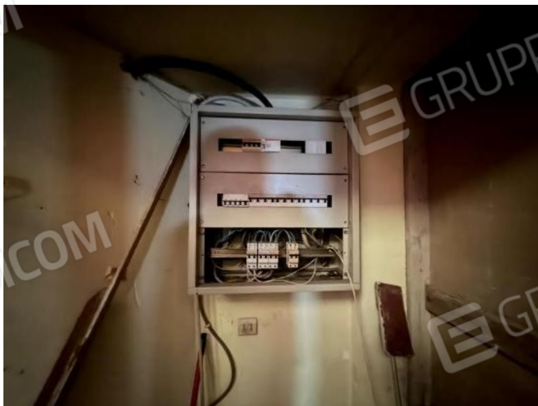
Particolare Quadro Elettrico sottoscala – in disuso
