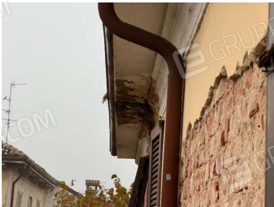
Particolare ammaloramento canale di gronda
