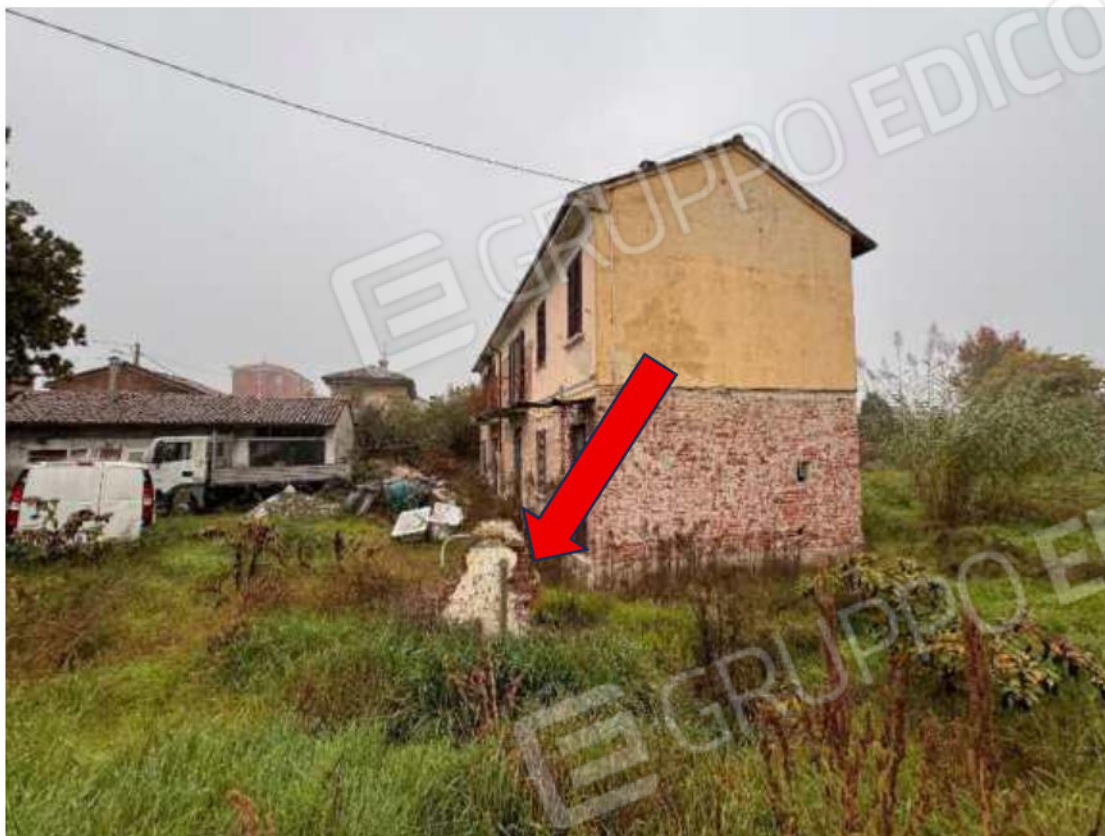
Vista Esterna della Proprietà – la freccia identifica i resti di un corpo accessorio oramai in rovina
