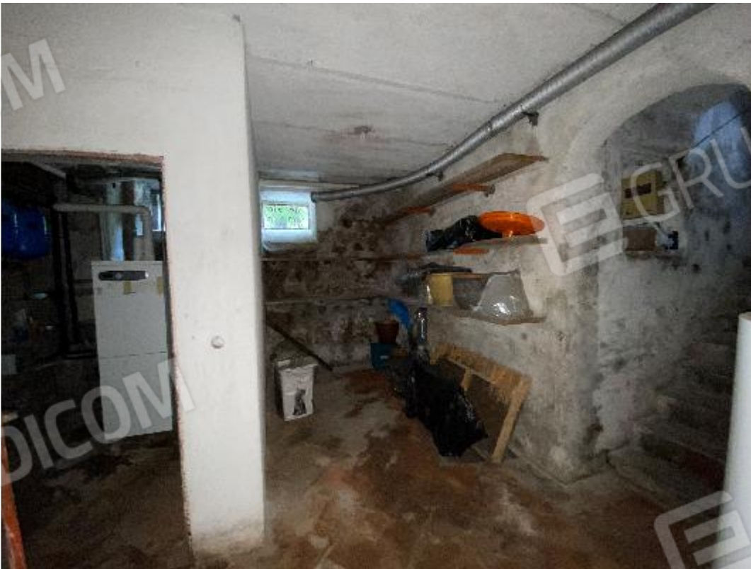
29. cantina con centrale termica
