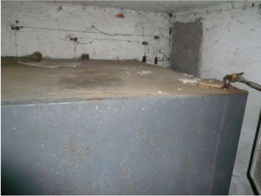
Foto 39 – Serbatoio gasolio non accessibile
