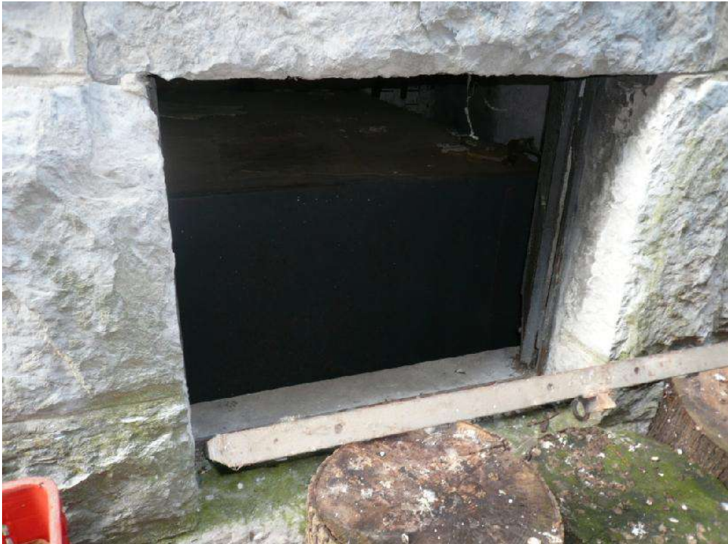
Foto 40 – Serbatoio gasolio non accessibile
