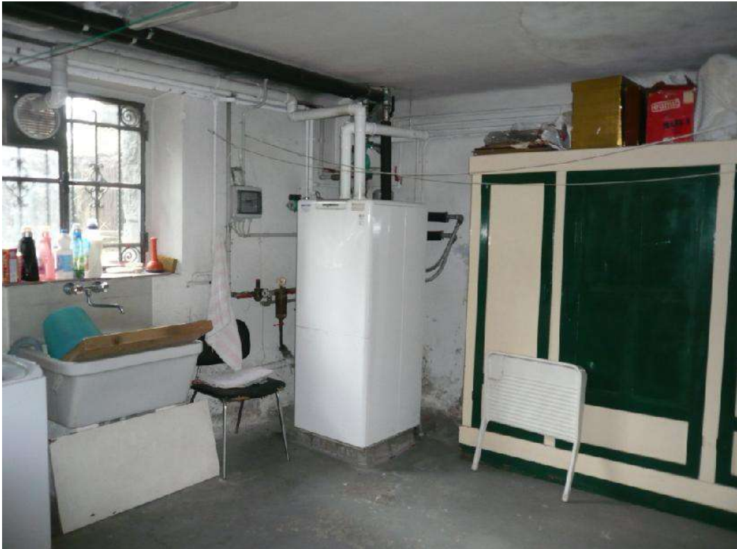
Foto 34 – Cantina con caldaia
