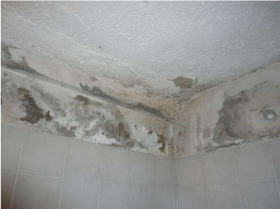
Foto 36 – Efflorescenza sul soffitto del bagno
