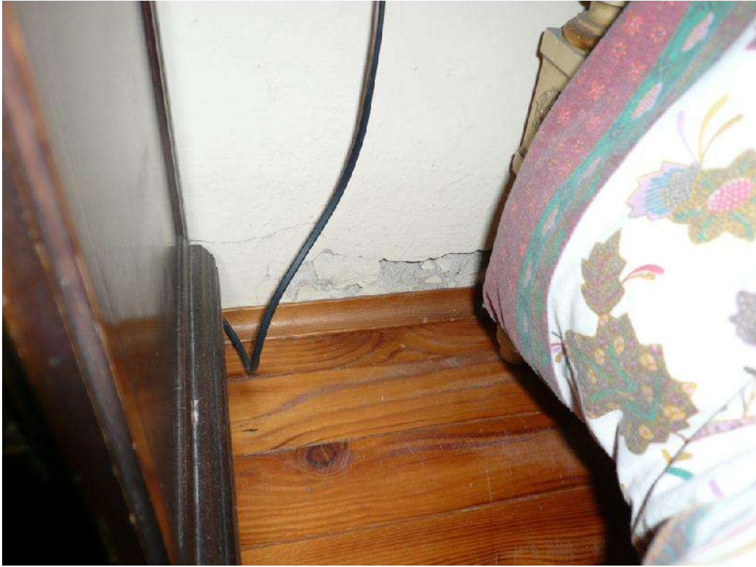
Foto 22 – Fenomeno di distacco dell’intonaco in camera, parete nord
