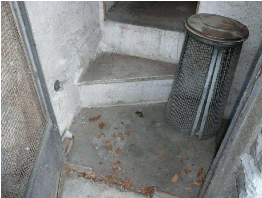
Foto 37 – Accesso cantina non comunicante con l'area abitabile
