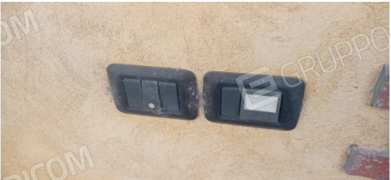
FOTO 11: prospetto del complesso edilizio sulla corte interna con particolare delle pulsanti corrispondenti ad un impianto elettrico nuovo
