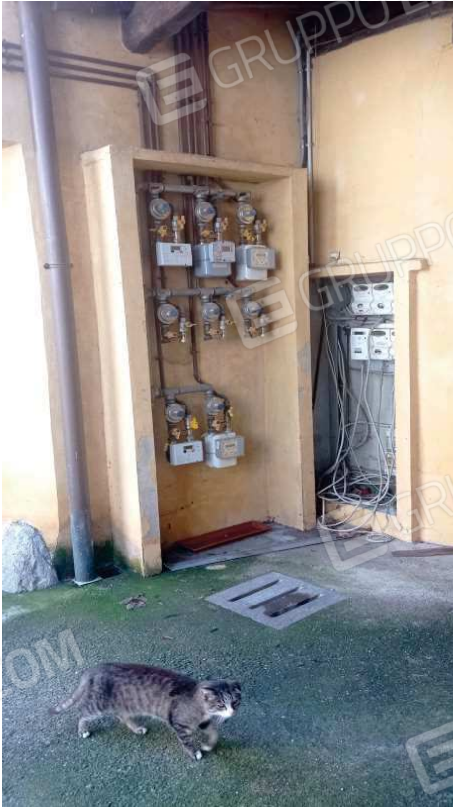
FOTO 13: prospetto del complesso edilizio sulla corte interna con particolare dei contatori dell'elettricità
