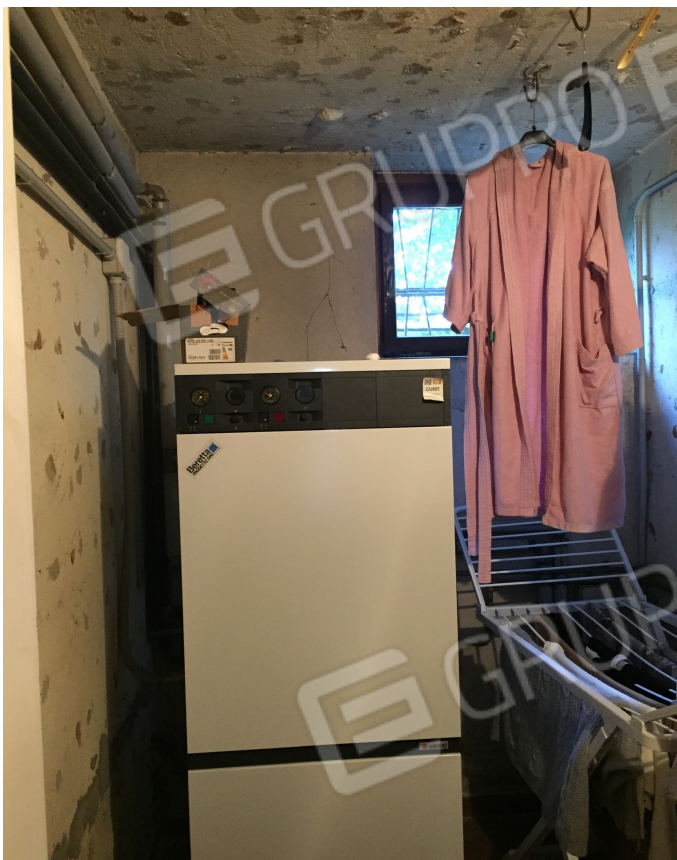
FOTO N. 11 LOCALE CALDAIA (INTERRATO)
