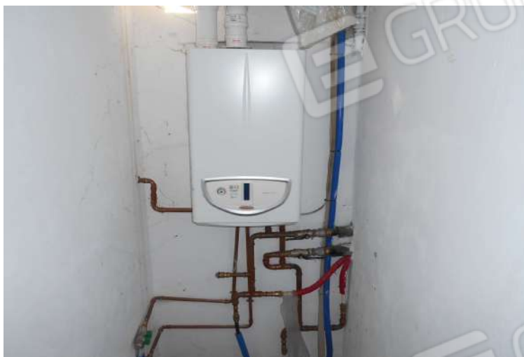
interni - secondo piano ristrutturato - impianto riscaldamento
