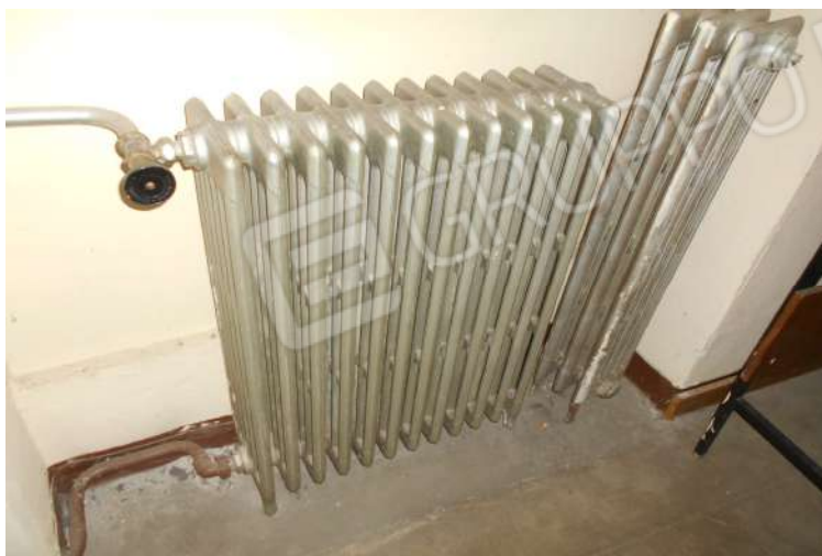
interni - impianto riscaldamento a radiatori
