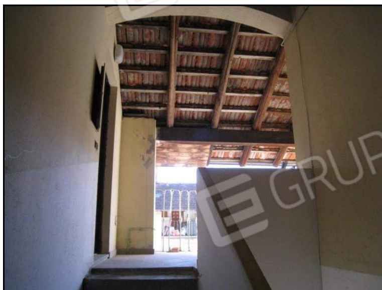
FOTO 6 VISTA DEL PIANEROTTOLO DI ARRIVO DELLA SCALA COMUNE AL PIANO SECONDO OVE E' UBICATA L'U.I. OGGETTO DI PROCEDURA
