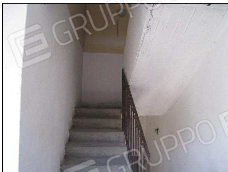
FOTO 5 ALTRA VISTA DELLA SCALA COMUNE CHE COLLEGA AI PIANI SUPERIORI E ALL'U.I. OGGETTO DI PROCEDURA.
