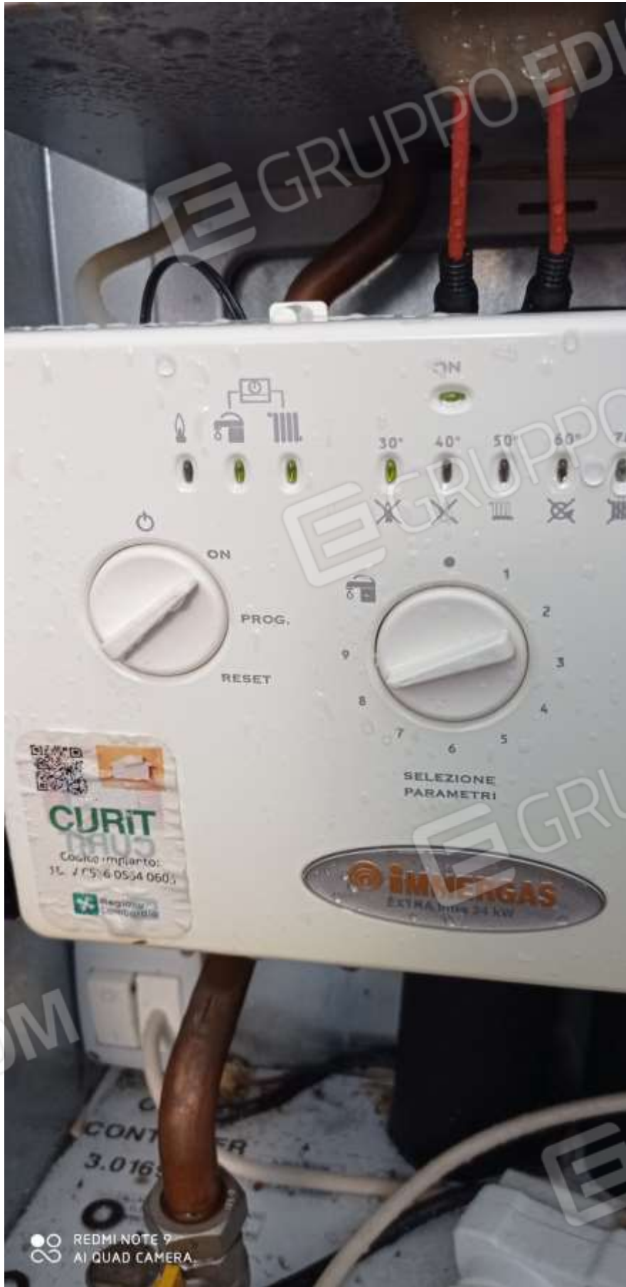
FOTO 25 – Particolare della caldaia
