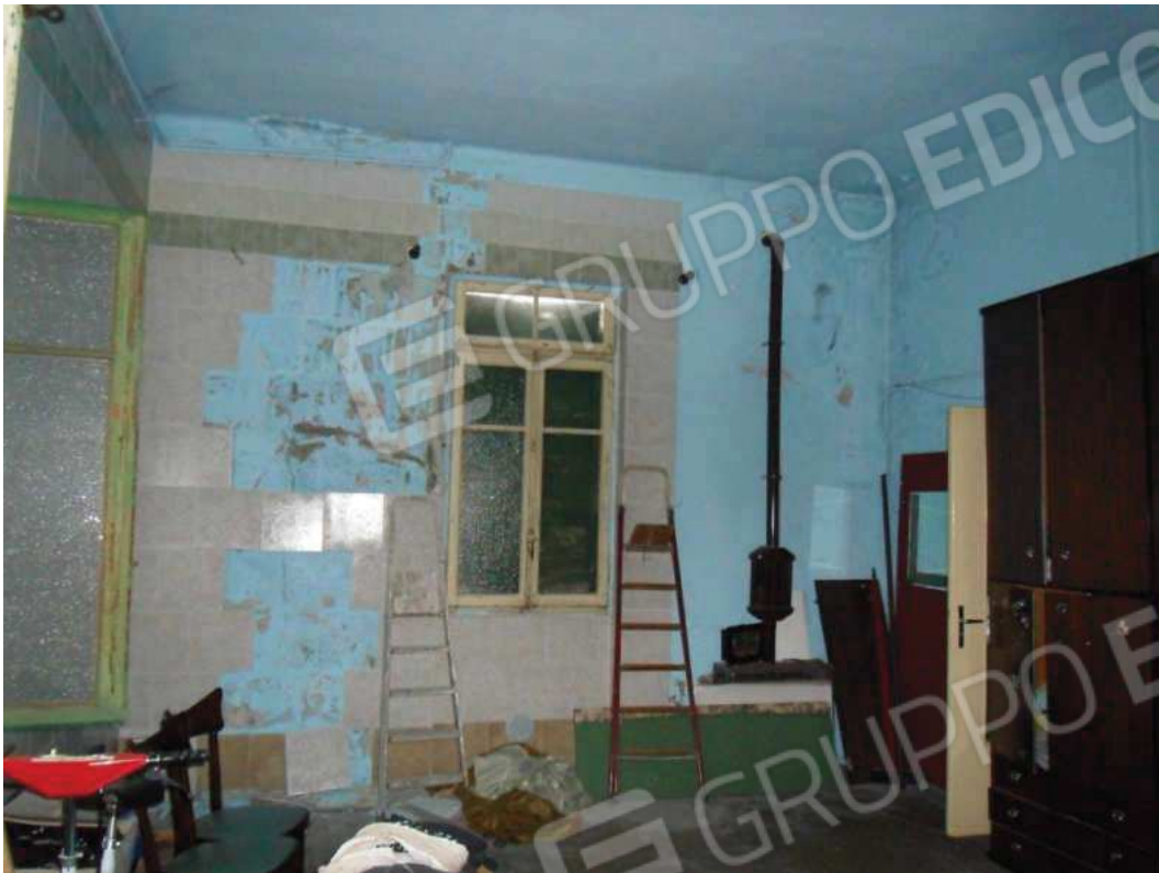
Locale 12 – Ripostiglio con fenomeni di macchie sulle pareti; locale non riscaldato
