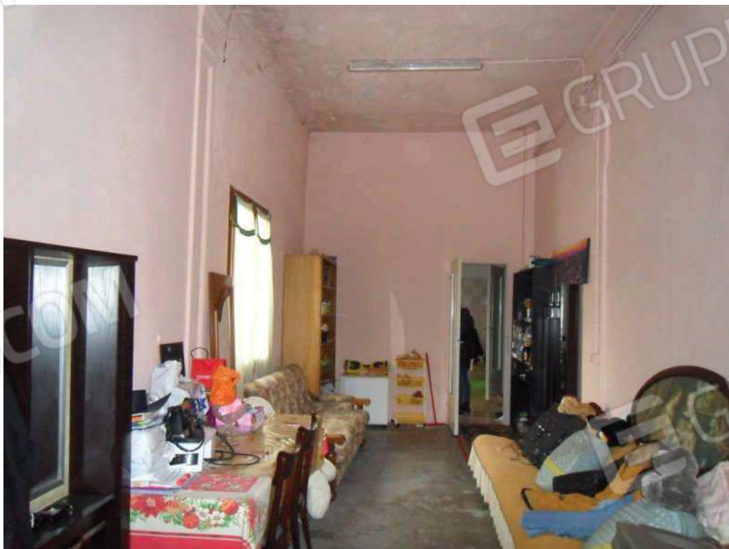
Locale 11 – Veranda chiusa con fenomeni di efflorescenza sul soffitto
