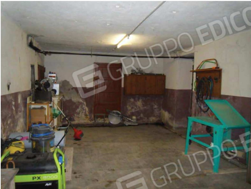
Locale 7 – Cantina; pareti affette da fenomeni di efflorescenza e distacco
