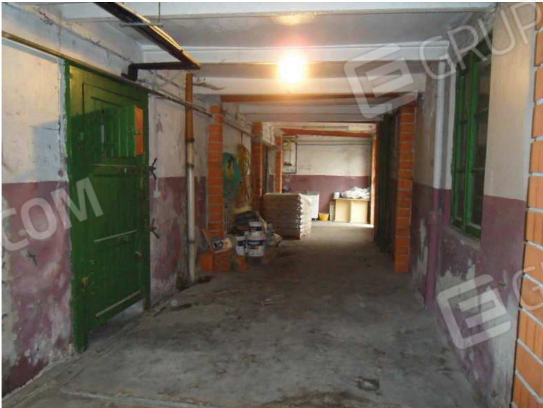
Locale 2 – Ripostiglio; pareti affette da fenomeni di efflorescenza e distacco
