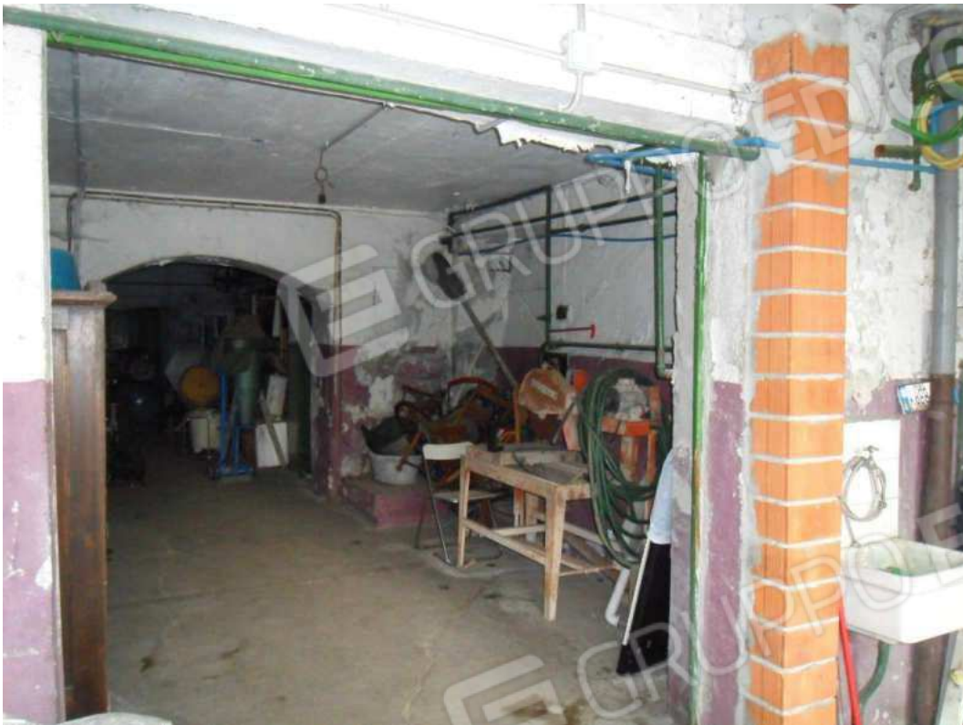
Locale 3 – Ripostiglio; pareti affette da fenomeni di efflorescenza e distacco
