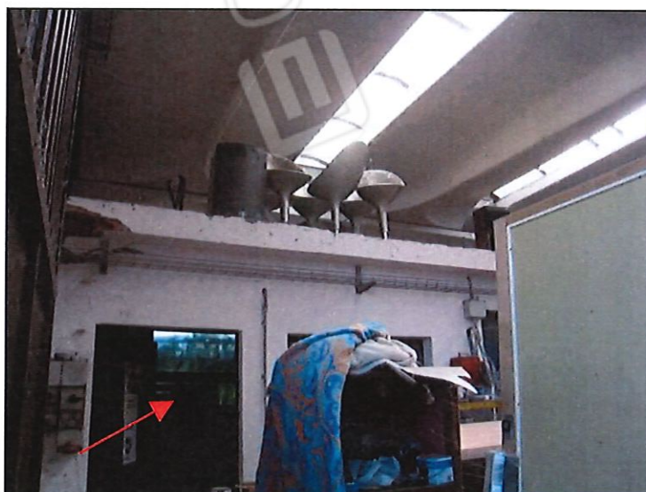
FOTO 2 VISTA INTERNA DELL'IMMOBILE OGGETTO DI PROCEDURA RIPRESA VERSO VANO REALIZZATO SENZA TITOLO ABILITATIVO.
