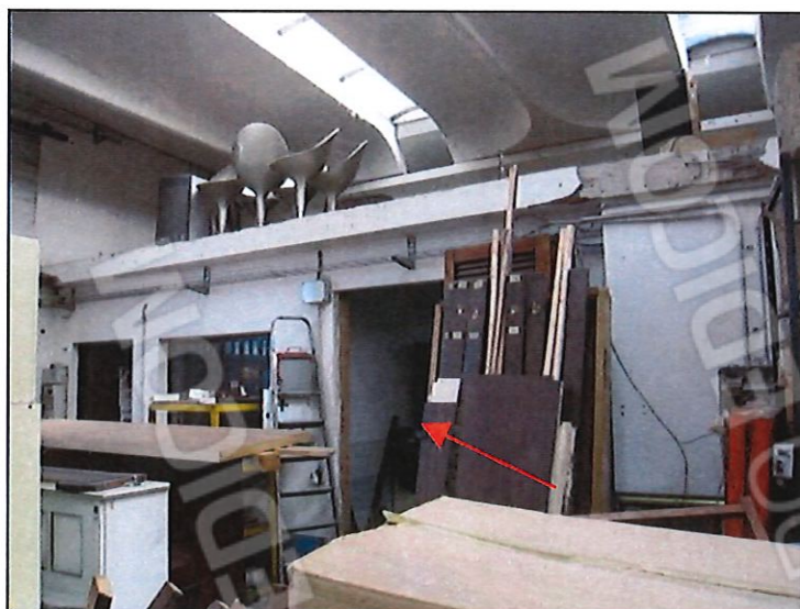
FOTO 3 ALTRA VISTA INTERNA DELL'IMMOBILE OGGETTO DI PROCEDURA RIPRESA VERSO VANO DELLA FOTO PRECEDENTE REALIZZATO SENZA TITOLO ABILITATIVO..
