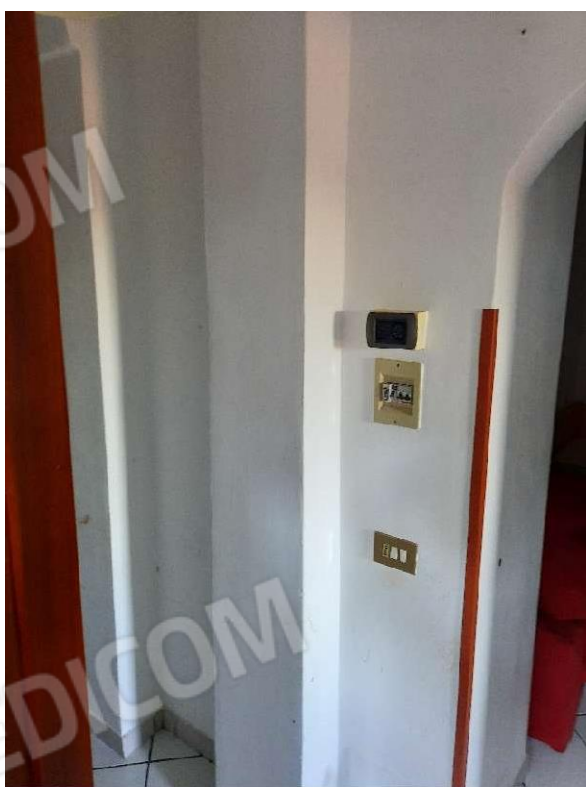
FOTO 6 – PARTICOLARE FRUTTI E PLACCHE IMPIANTO ELETTRICO
