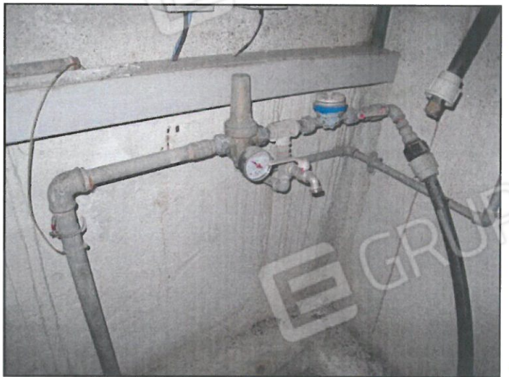
FOTO 42 VISTA CONTATORE COMUNE ACQUA POTABILE.
