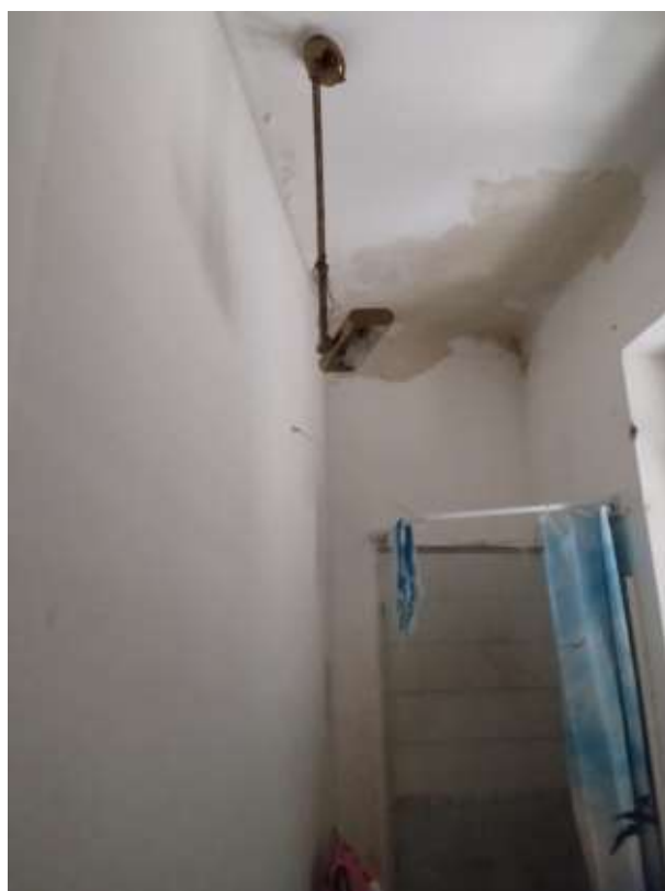
INFILTRAZIONI DI UMIDITA' IN BAGNO
