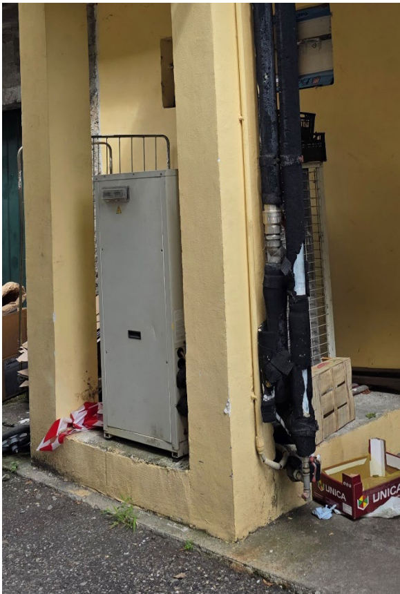
Foto 10 - 11 - Macchina esterna refrigerante – targa.
