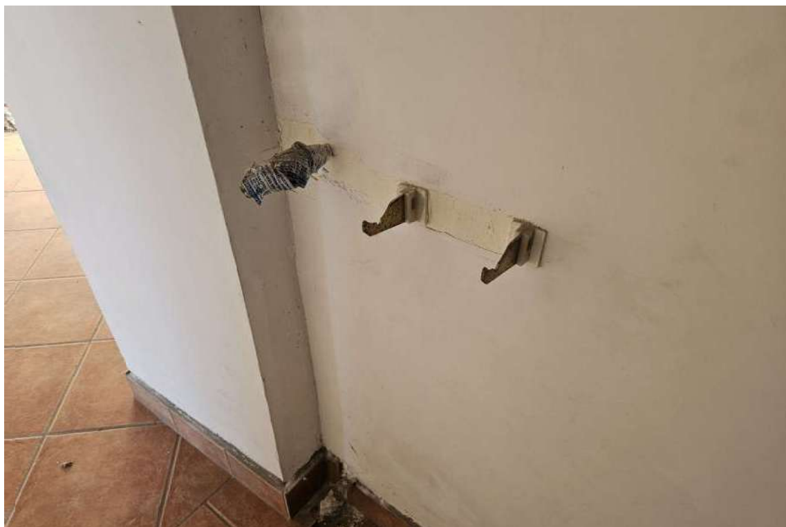
Impianto di riscaldamento senza radiatori
