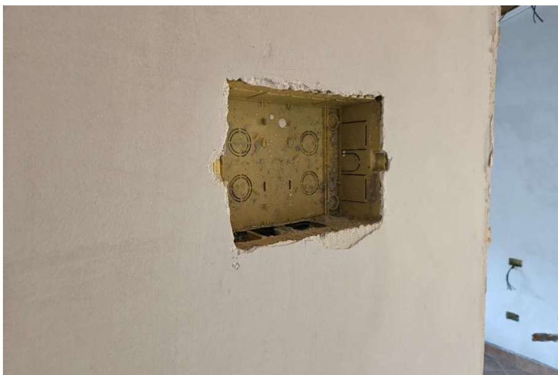
Quadro elettrico generale incompleto
