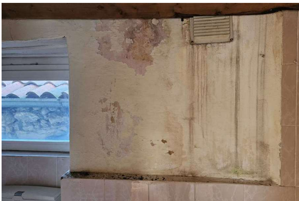
Infiltrazioni nel bagno
