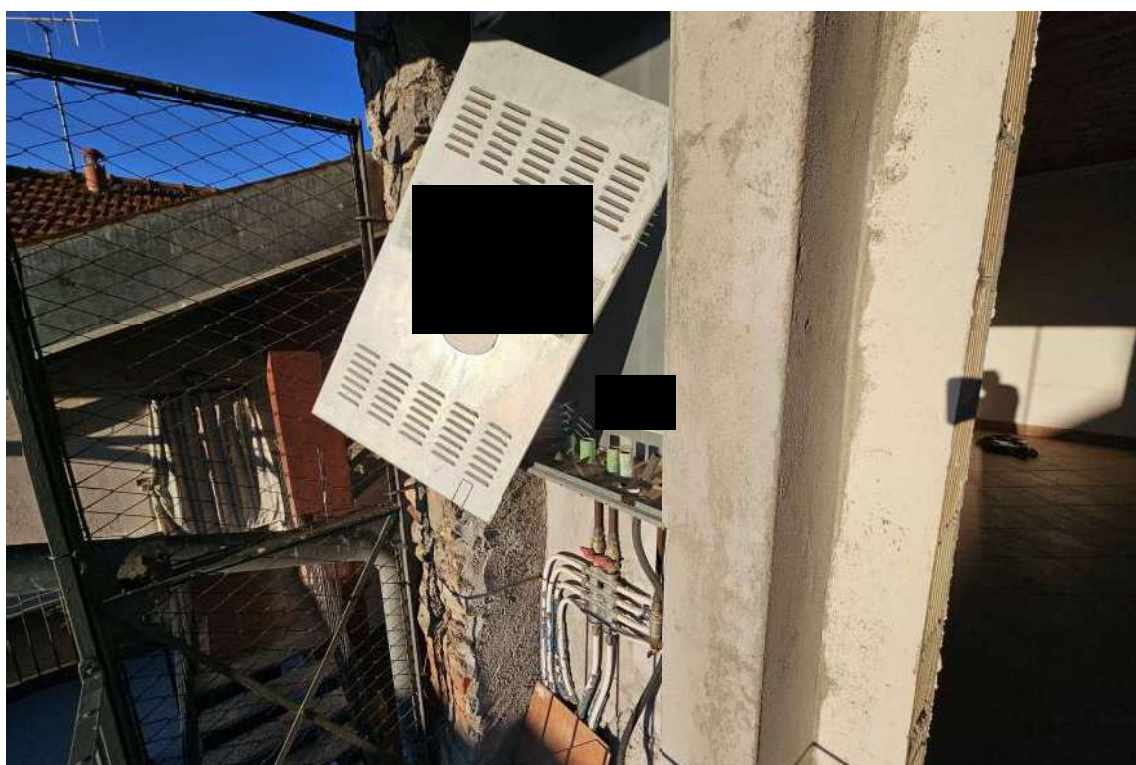
Vano caldaia (vuoto) dell'appartamento
