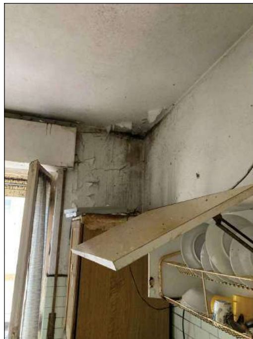
Foto 21 -CUCINA: DETTAGLIO DEL MURO VICINO LA FINESTRA
