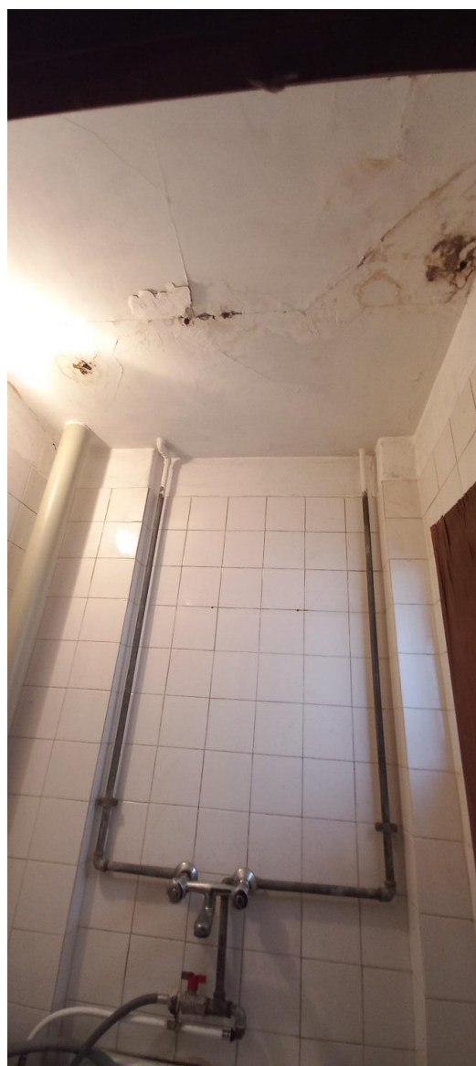
Infiltrazioni a soffitto
