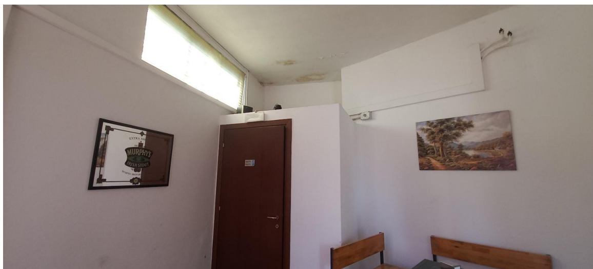
Locale consumazioni e wc utenti
