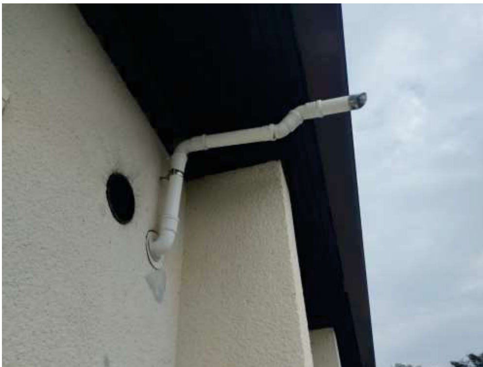
PARTICOLARE ESALAZIONE FUMI CALDAIA CUCINA
