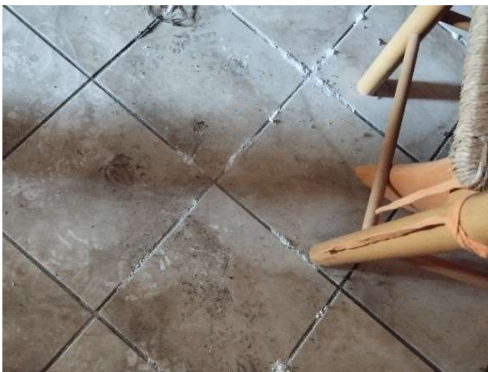
PARTICOLARE EFFLORESCENZE PIANO TERRA
