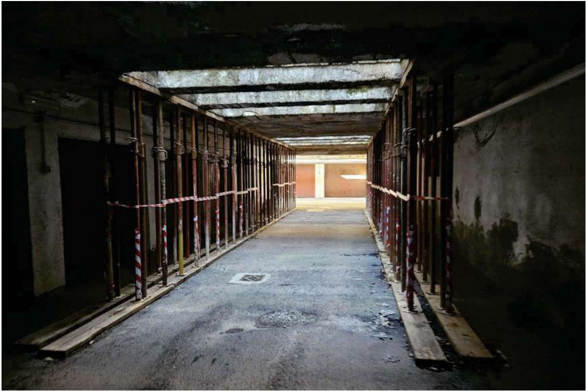
Porzione di corsello ai box con problematiche di infiltrazione
