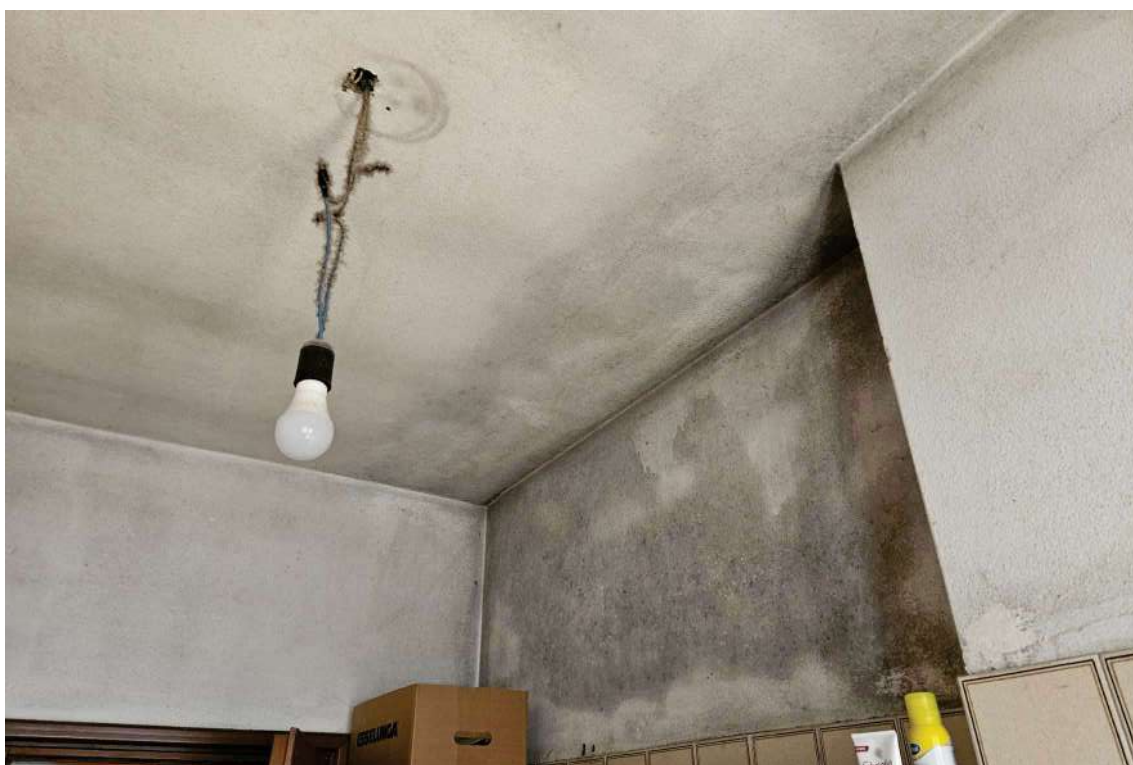
Vistosa formazione di muffe nel bagno
