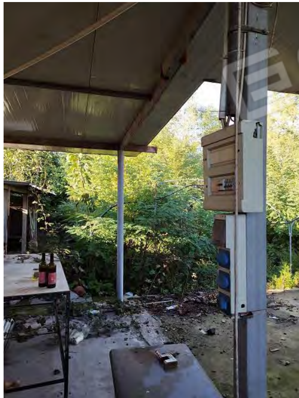
FOTO N. 10 – Vista del quadro elettrico posto al di sotto della tettoia
