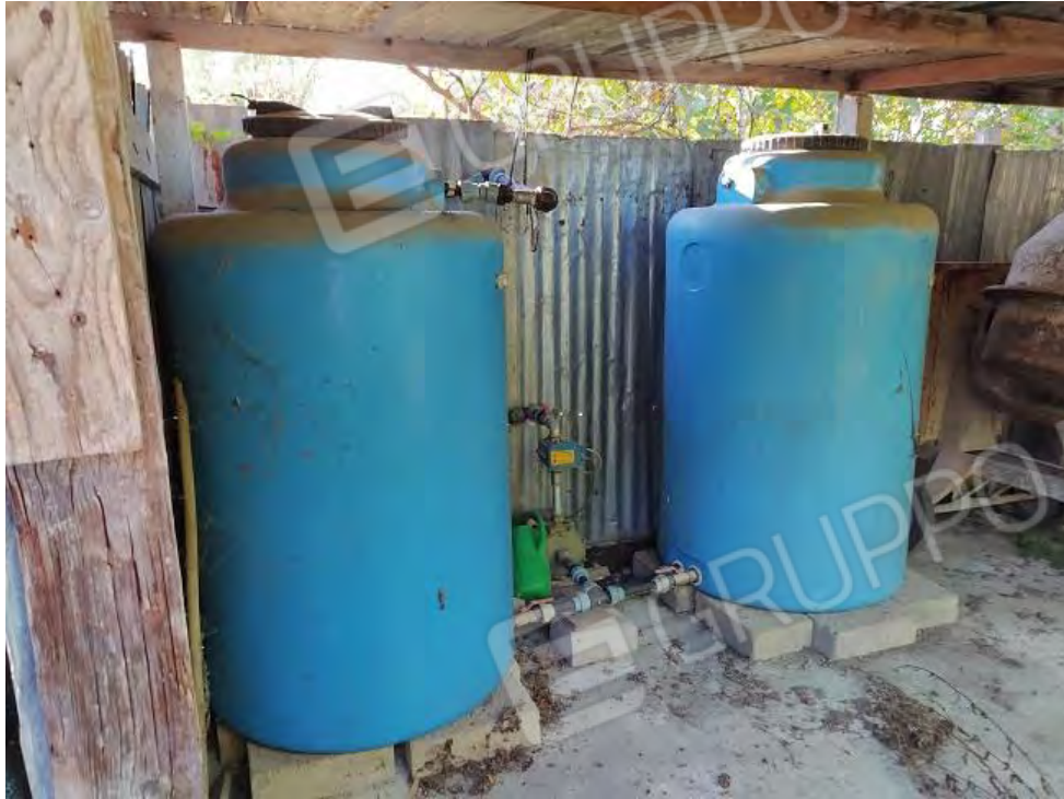
FOTO N. 7 – Serbatoi di raccolta acqua collegati all’impianto autoclave
