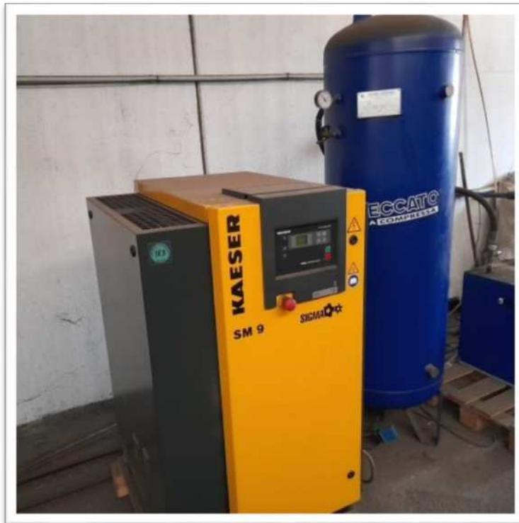
FOTOGRAMMA N. 13 - COMPRESSORE KAESER CON UNITA' DI ESSICCAZIONE
