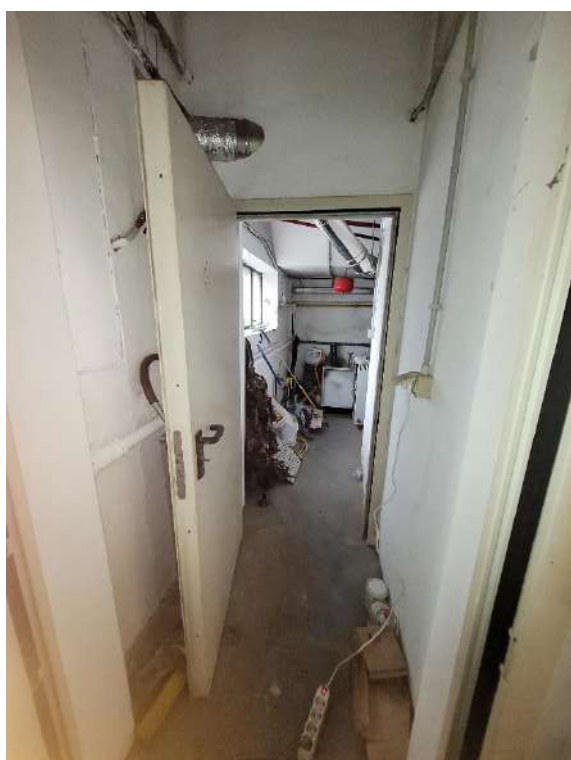
FOTO 39 – anti locale caldaia
