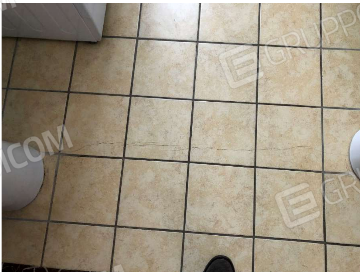
Foto n. 22 – I quadri fessurativi
