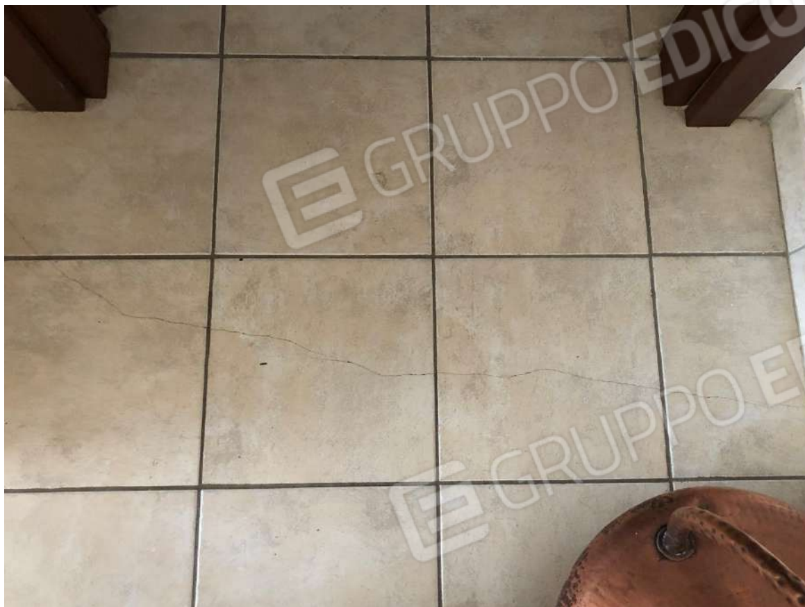
Foto n. 19 – I quadri fessurativi
