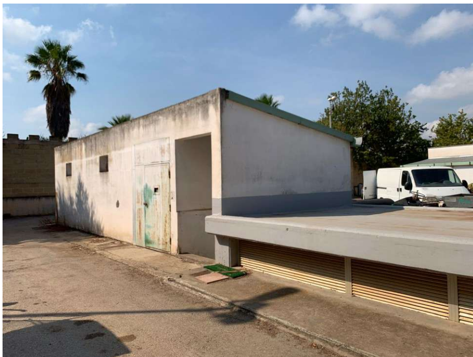
FOTO 16 - STAZIONE DI POMPAGGIO
