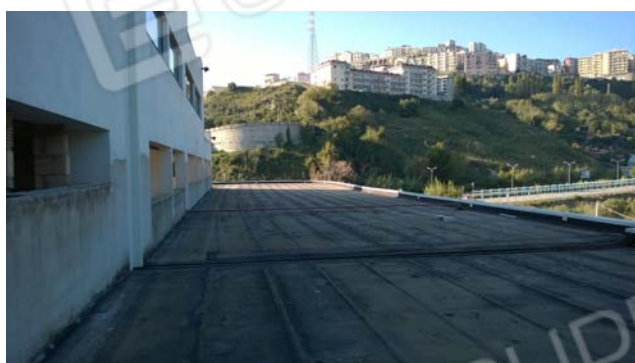
Foto 64 - LOTTO 5 - Piano 2° - sub.466
