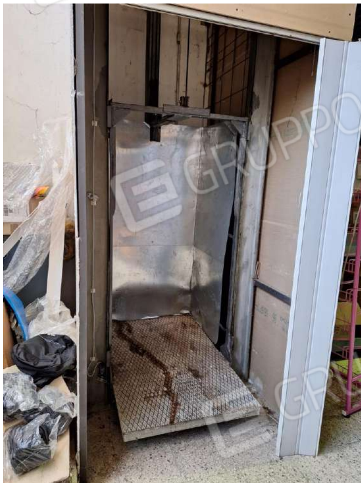
Foto N.9 – Particolare montacarichi interno al capannone
