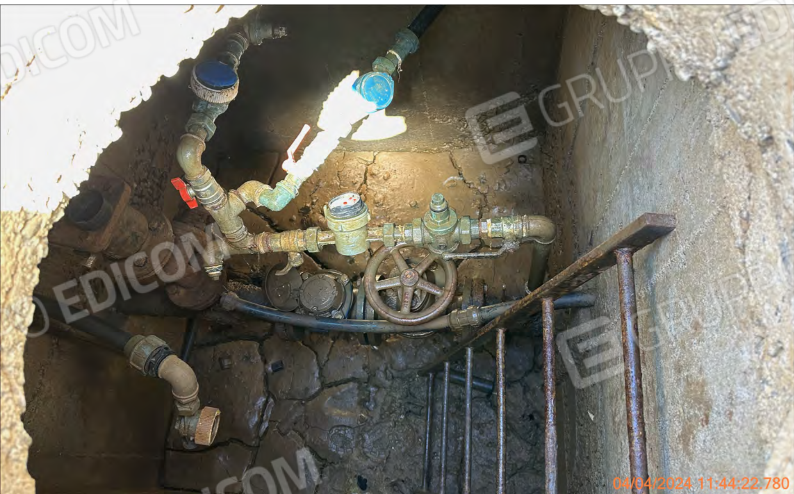
FOTO 18 pozzetto sorical (allaccio attualmente distaccato).jpg
