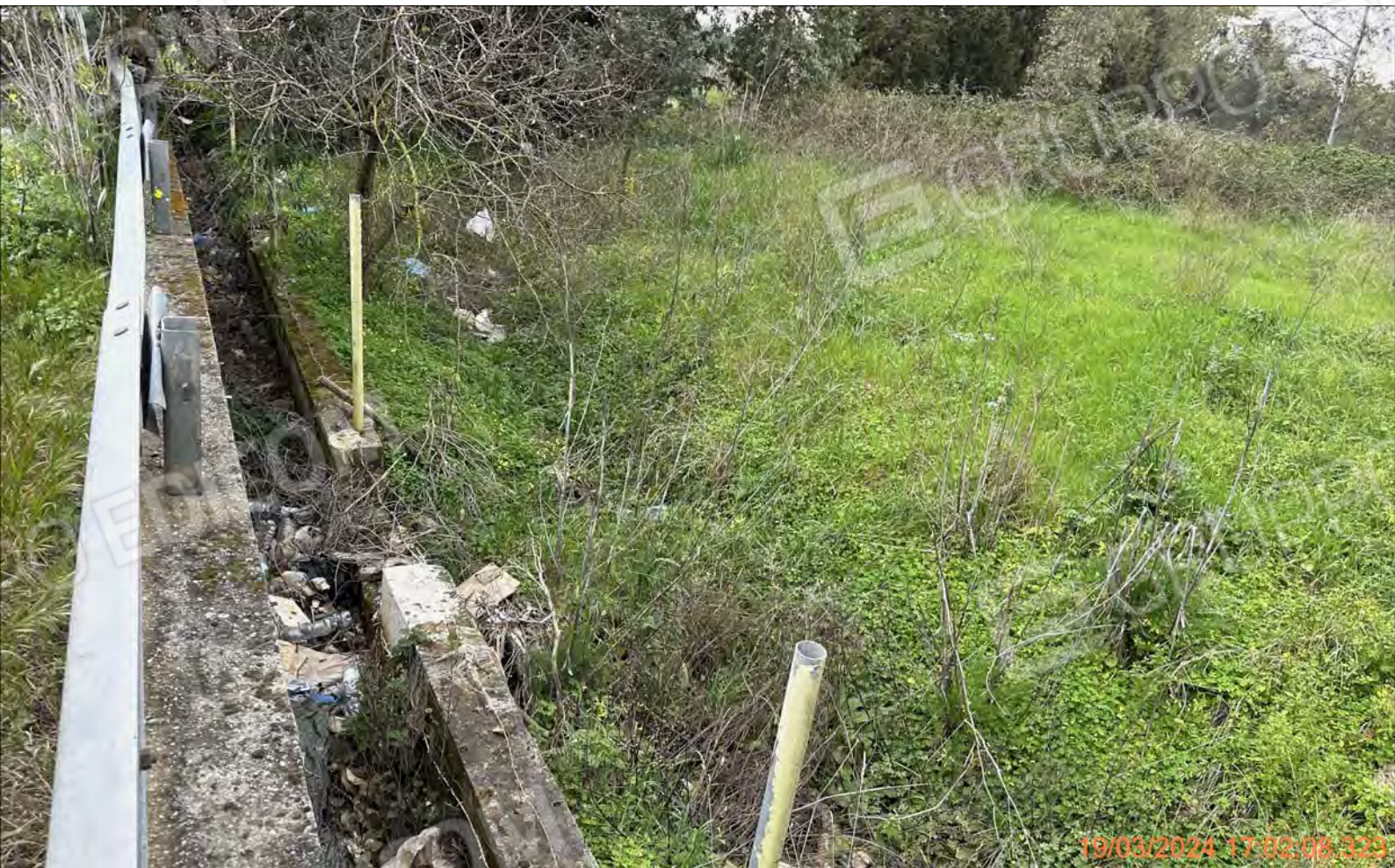
FOTO 24 canale raccolta acque lato est.jpg
