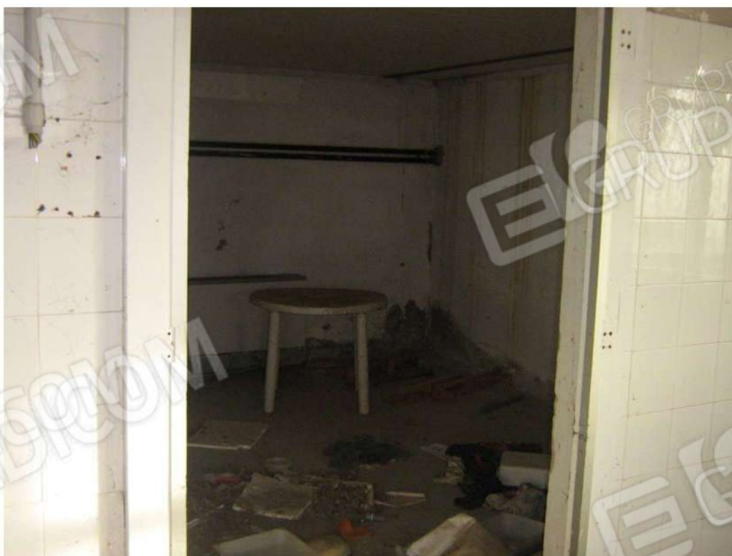
Foto n. 62: particolare vano interno - Fabbricato "C" (lotto n. 4).
