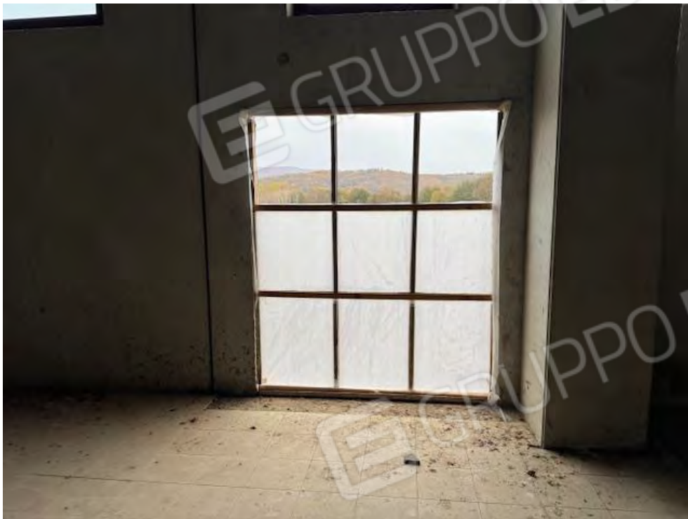
Foto n. 17 Piano terra – Vano 2 – Infisso assente
