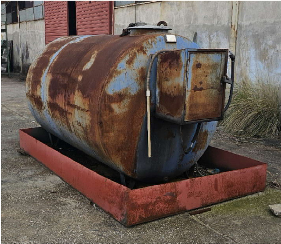
SERBATOIO GASOLIO CON EROGATORE – ID 1-
