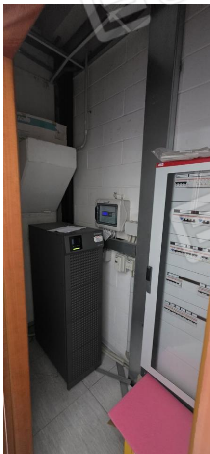
Locale tecnico (P1)
