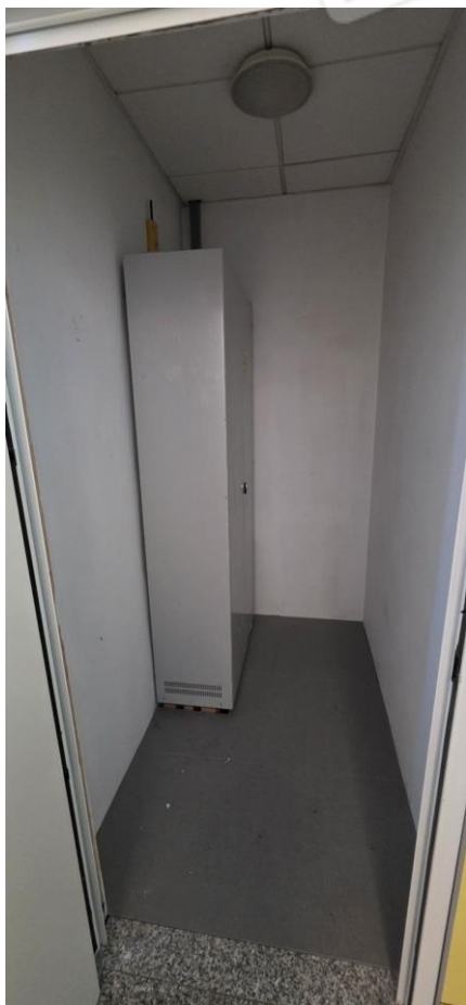
Locale ascensore (P2)
