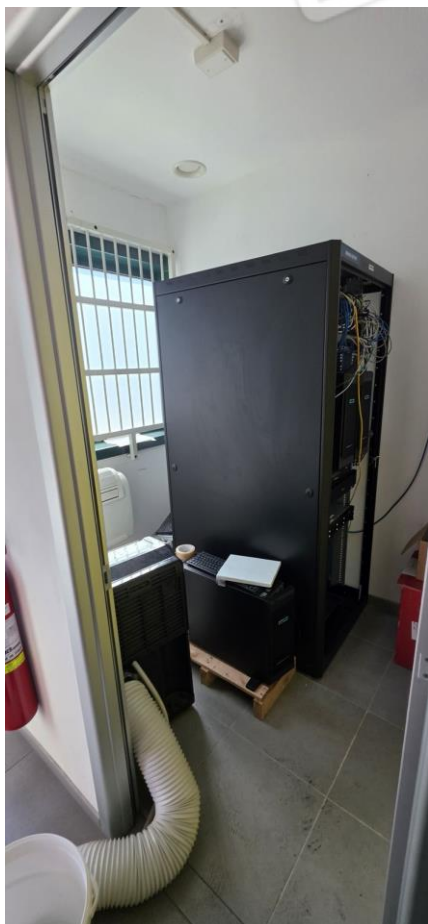
Locale tecnico (PT)
