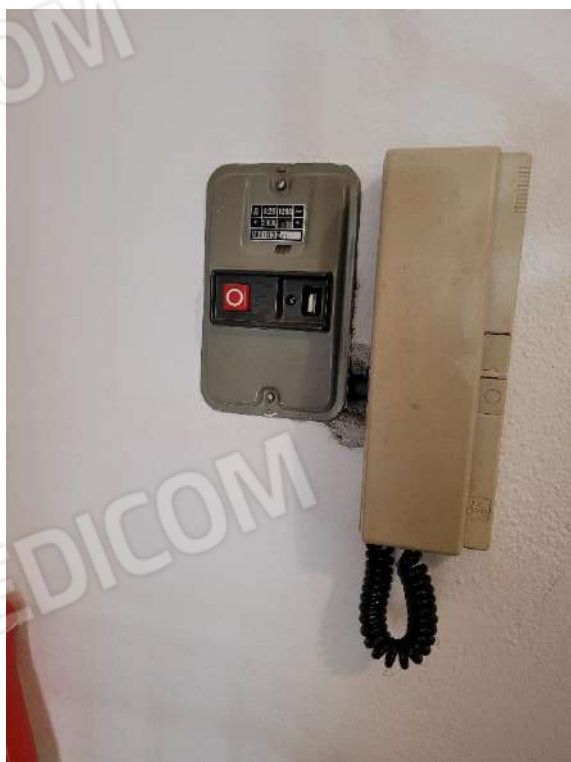
Foto 11- "Quadro" elettrico interno
